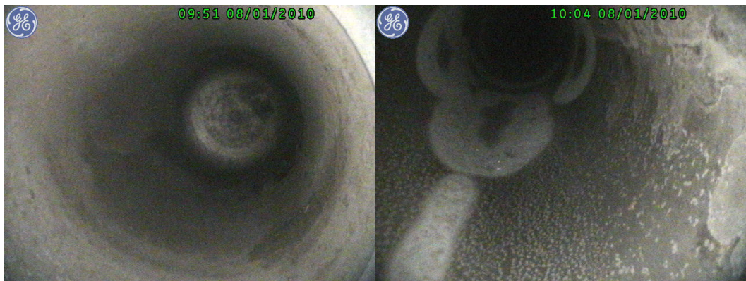
Obr. 23 a 24 Fotografie z kontroly dutiny nosníku Z 226 MS, OK-MPT
