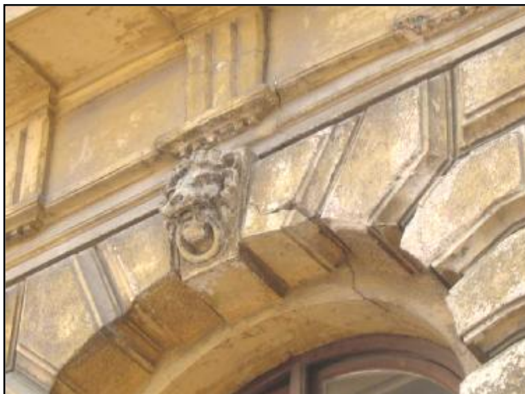
Obr. 37 - Detail trhliny, šířka 3 mm v omítce [15]
