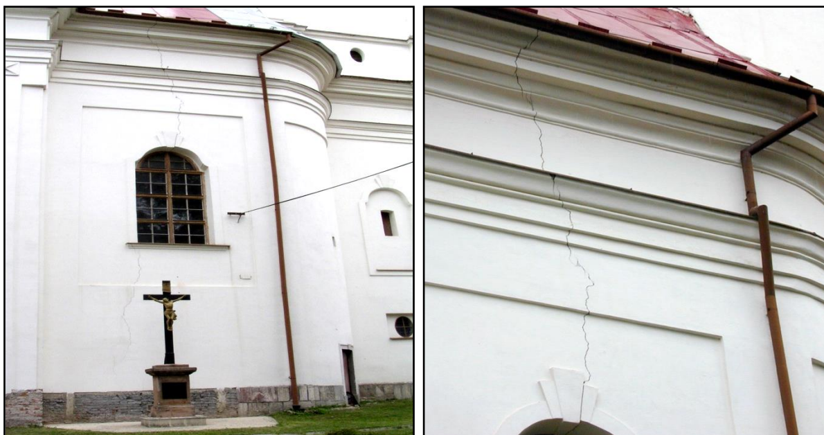
Obr. 32 - Pohled na jižní zeď kostela [14]
