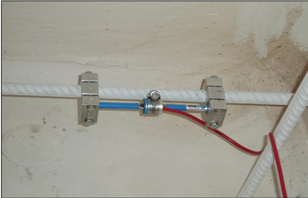
Obr. 30 - Příklad měření pomocí tenzometru Geokon umístěného na táhlech
