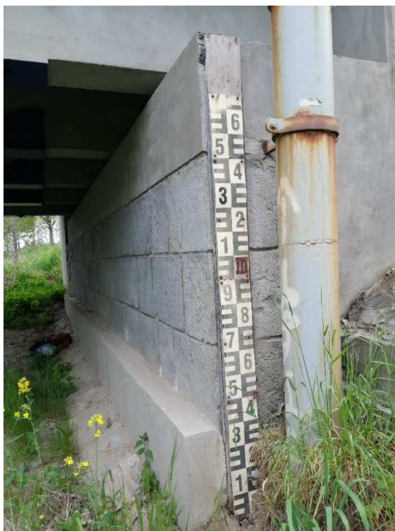
Obrázek 14: Vodočetná lať Uničov.
