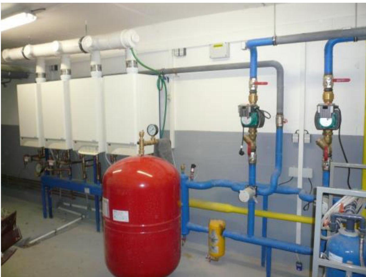
Vybavení vlastní plynové kotelny
