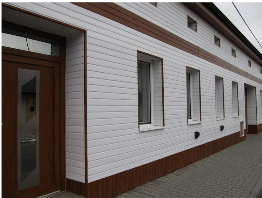
Obr. 31 – plastový obklad imitující dřevo s bílým nátěrem [26]
