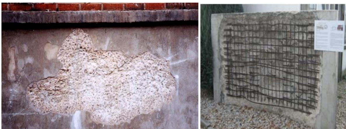
Obr. 3.26 Ukázka odštěpování povrchové vrstvy betonu (různý rozsah) [38], [39]
