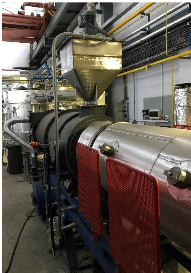
Obr. 8.1 Sušící pec (pohled 1)
