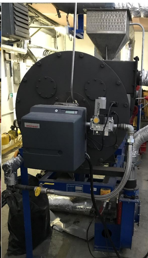
Obr. 8.2 Sušící pec (pohled 2)
