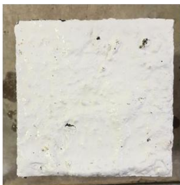
Obrázek 27 - Popraskaný nátěr na vzorku
