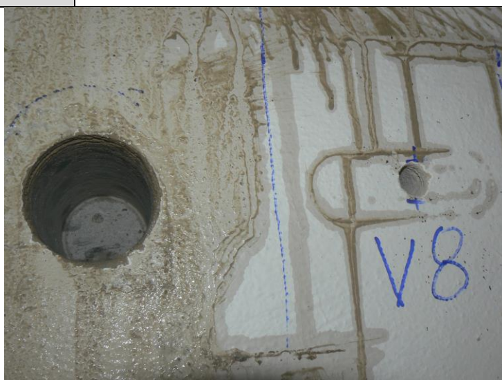
Obrázek 45 Pohled na průvlak P1-1 s odebraným vývrtem V8
