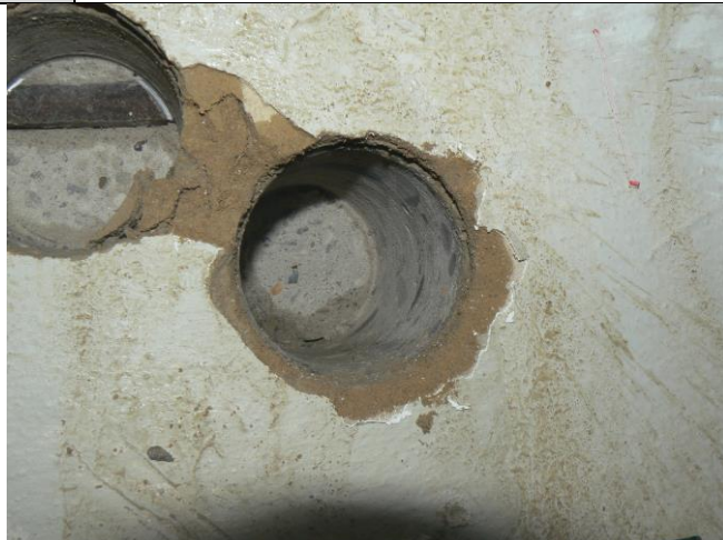
Obrázek 49 Pohled do vývrtu V2 z průvlaku P2-2 a do vývrtu s porušenou výztuží
