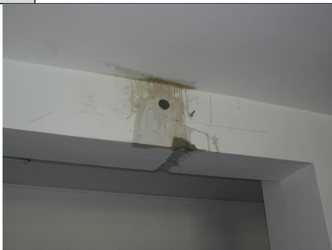
Obrázek 47 Pohled na průvlak P2-2 s odebraným vývrtem V1
