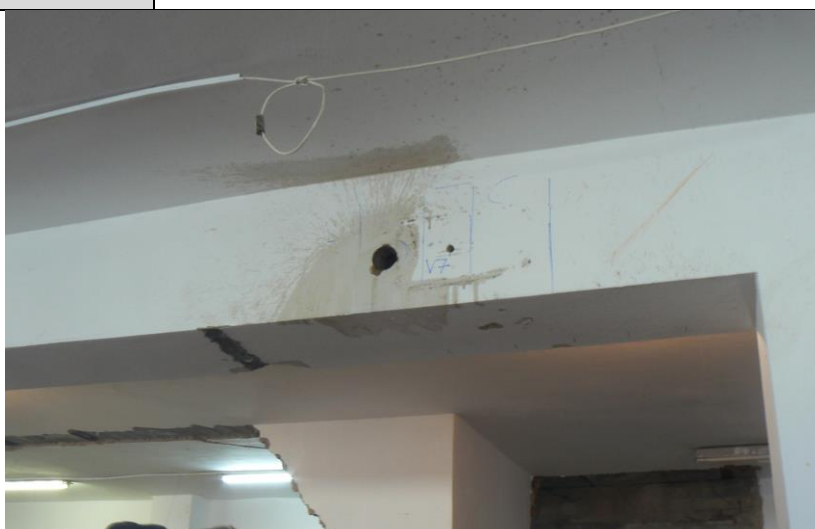
Obrázek 43 Pohled na průvlastku P1-2 s odebraným vývrtnem V7
