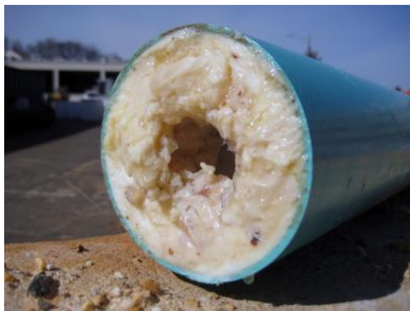
Obr. 4 Zanesené potrubí následkem znečištění FOG [17]
