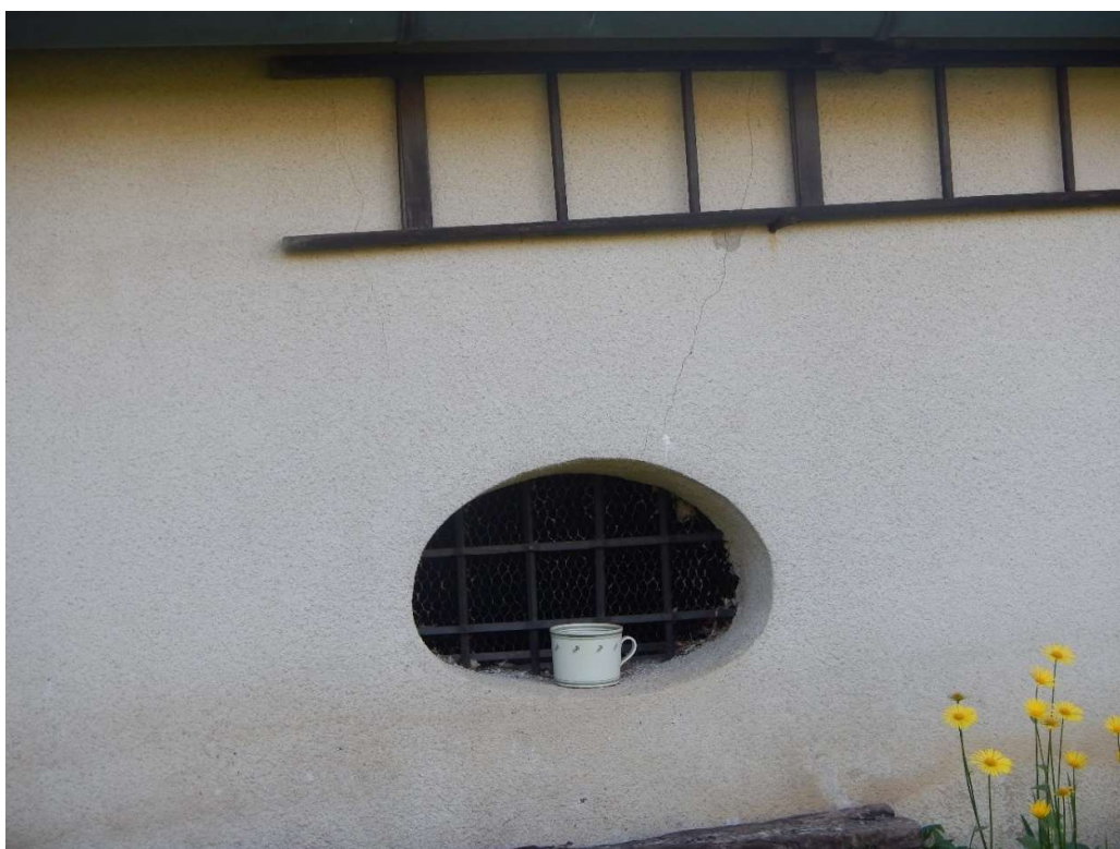
Obr. 21 – Trhlina na severní zdi. Fotografie z archivu autora bakalářské práce.
