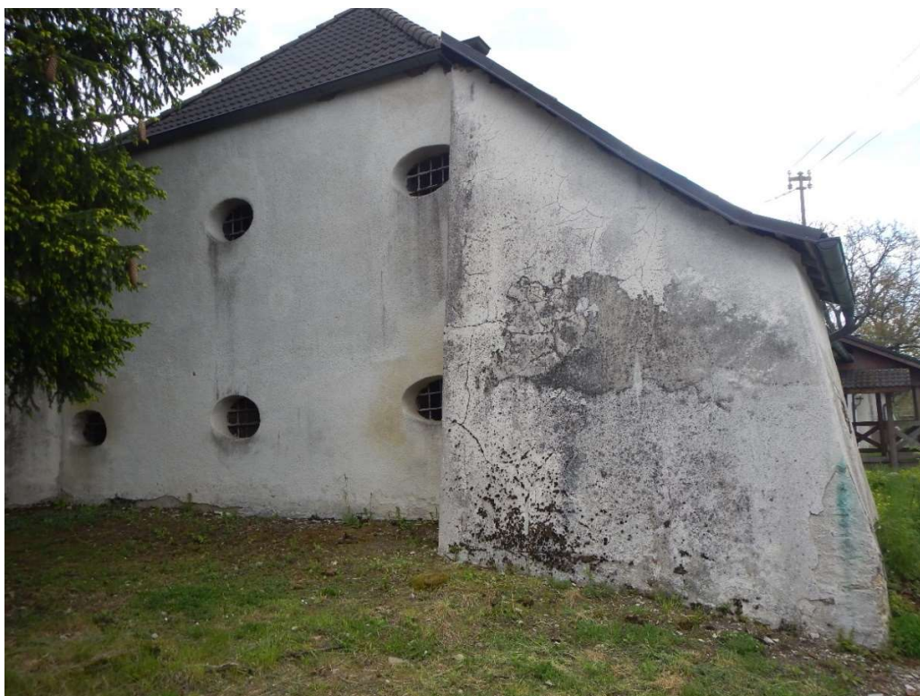
Obr. 20 – Omítka na opěráku, trhliny viditelné díky přítomnosti mechu a lišejníků, nároží opěráku poškozeno dopravou. Fotografie z archivu autora bakalářské práce.
