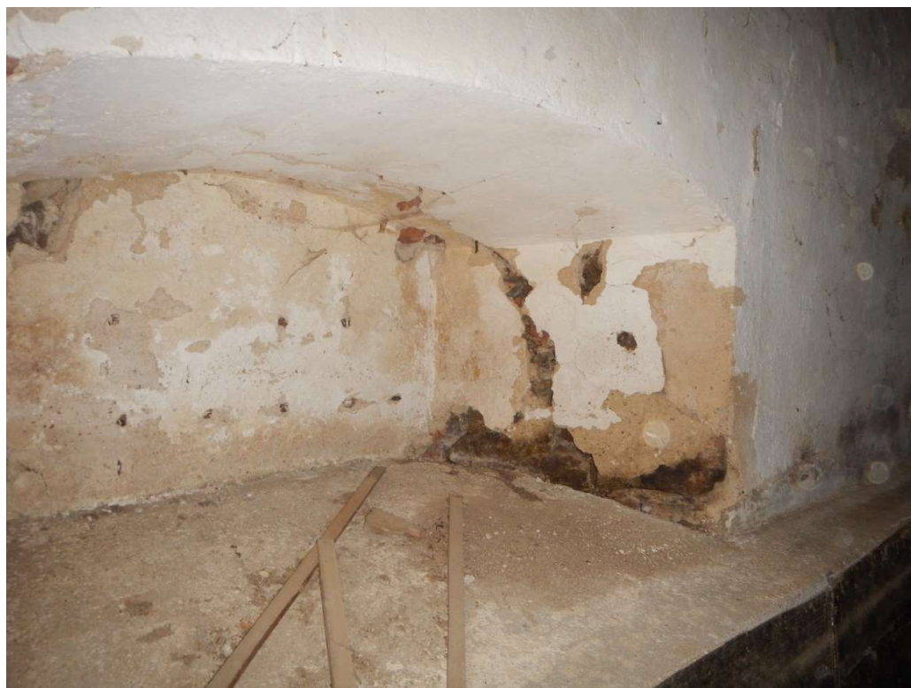
Obr. 22 – Trhlina v přízemí u zazděného otvoru v severní zdi. Fotografie z archivu autora bakalářské práce.
