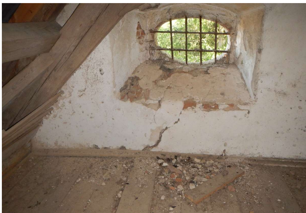
Obr. 24 – Trhlina v 2.NP v severozápadní zdi. Fotografie z archivu autora bakalářské práce.
