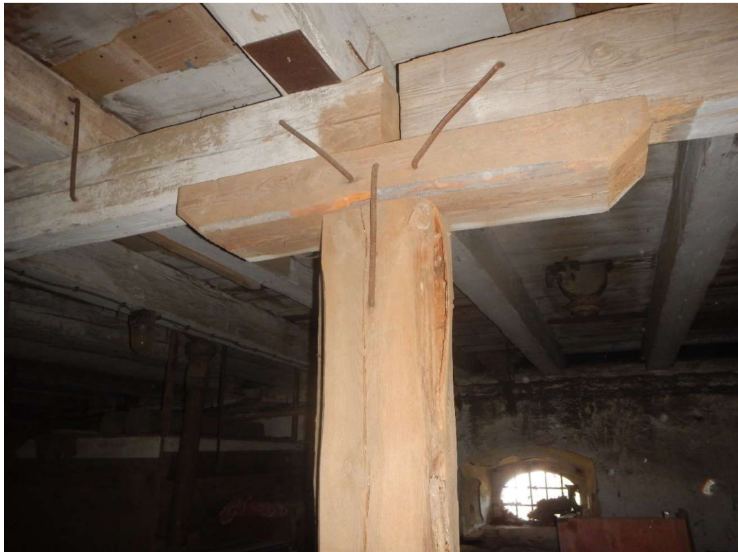
Obr.29 – Porucha hlavy sloupu v 1.NP. Fotografie z archivu autora bakalářské práce.
