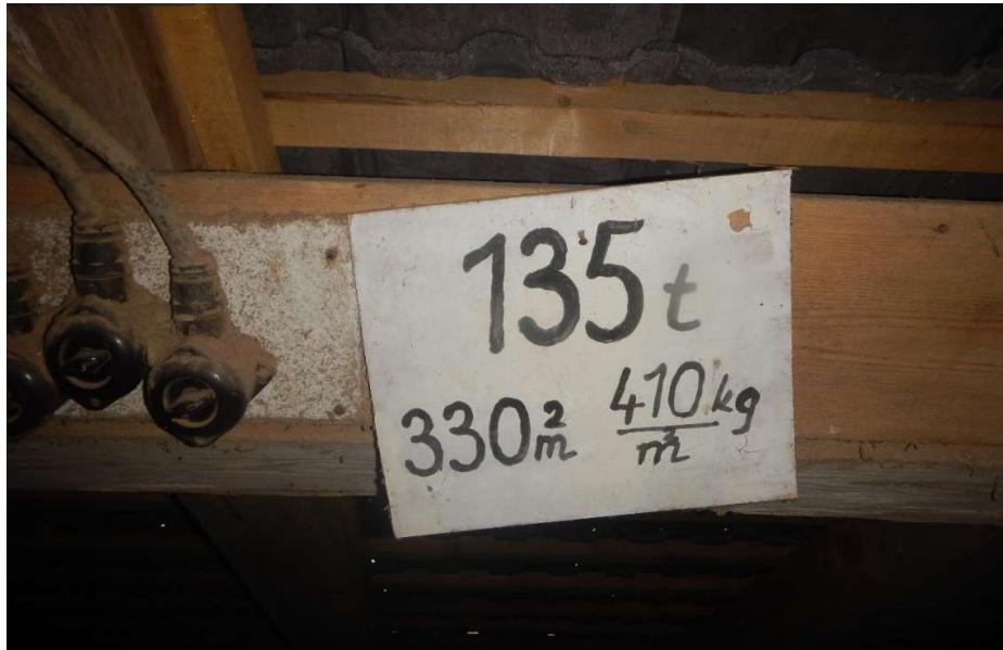
Obr. 8 – Tabulka o maximálním zatížení umístěna ve 2.NP naproti schodišti. Fotografie z archivu autora bakalářské práce.
