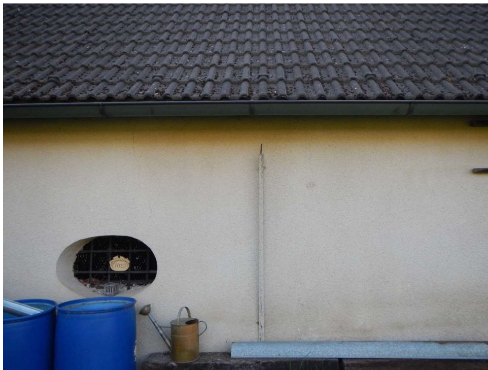
Obr.16 – Fragmenty ochrany před bleskem odstraněné během poslední rekonstrukce střechy. Fotografie z archivu autora bakalářské práce.
