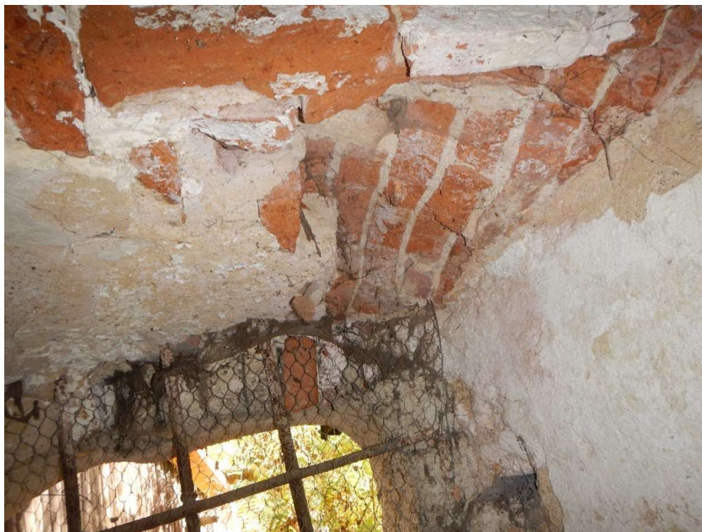
Obr. 11 – Odpadaná omítka v nadpraží větracího otvoru ukazující použití plných pálených cihel v klenbě. Fotografie z archivu autora bakalářské práce.
