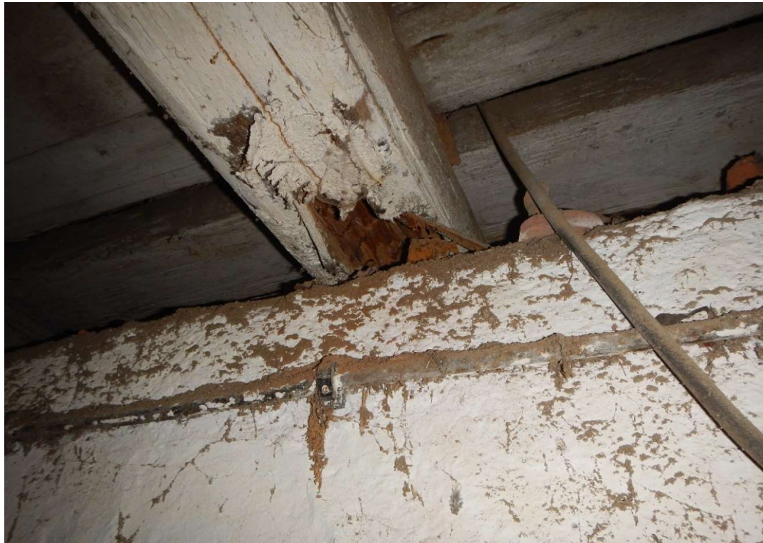
Obr. 28 – Ztrouchnivělé jádro stropnice. Fotografie z archivu autora bakalářské práce.
