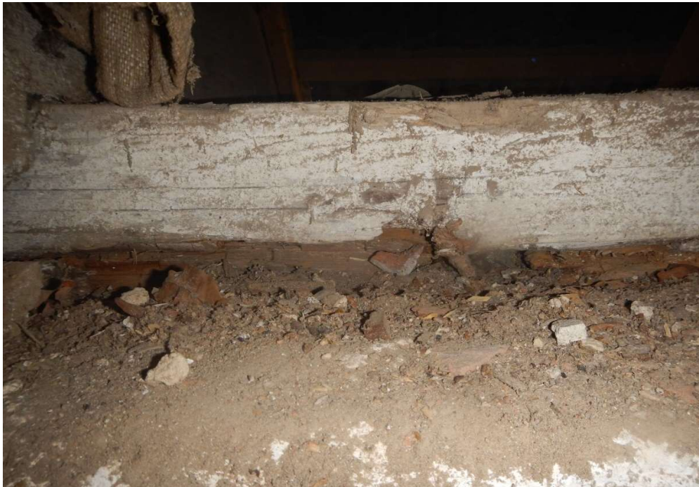
Obr. 26 – Pozednice po odkrytí nánosu nečistot. Fotografie z archivu autora bakalářské práce.
