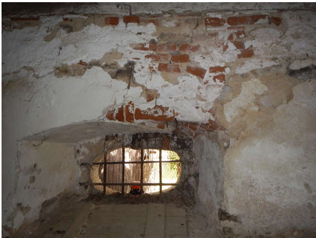
Obr. 23 – Poruchy v 1.NP v severozápadní zdi, po letmém přeměření nebyla odhalena deformace nosné části klenby. Fotografie z archivu autora bakalářské práce.
