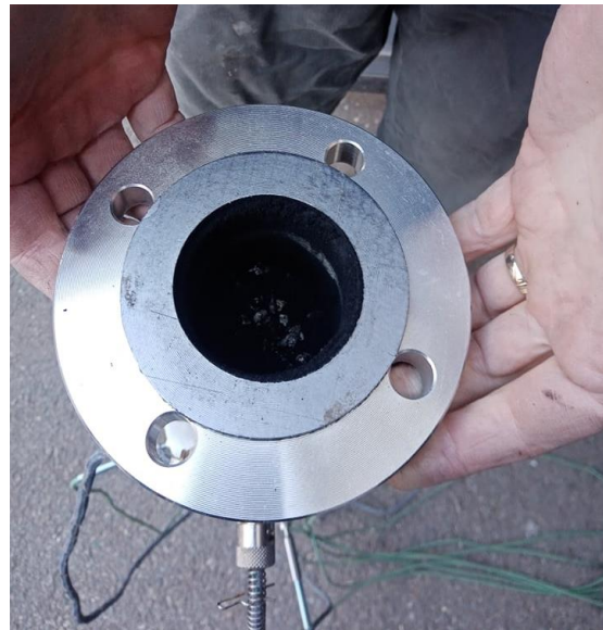
Obr.7.6 Pohled do lože katalytického filtru
