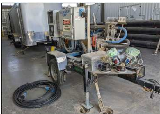
Obrázek 38: Vysokotlaké čerpadlo k vstřikování borové chladicí vody do reaktoru v elektrárně Palo Verde v Arizoně. Tato voda se vstřikuje do chladicího systému reaktoru, aby se udržela podkritičnost reaktoru, převzato z [146].
