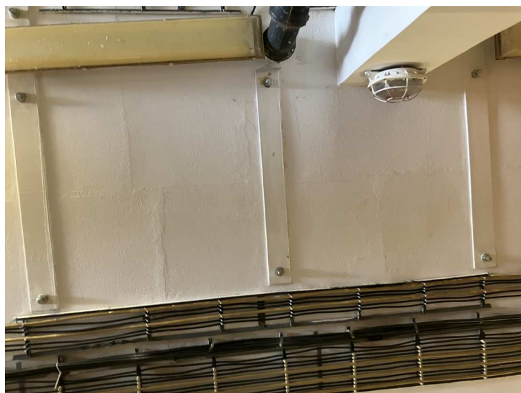
Obrázek 12: Seismické z odolnění hasičské zbrojnice na ETE. Jde o vyztužení pomocí ocelových plátů. Toto vyztužení bylo provedeno na všech patrech hasičské zbrojnice.
