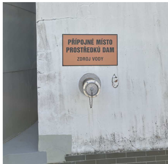
Obrázek 9: Přípojně místo nádrže s demineralizovanou vodou na ETE.
