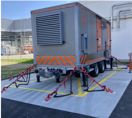
Obrázek 6: Mobilní čerpadlo na ETE.
