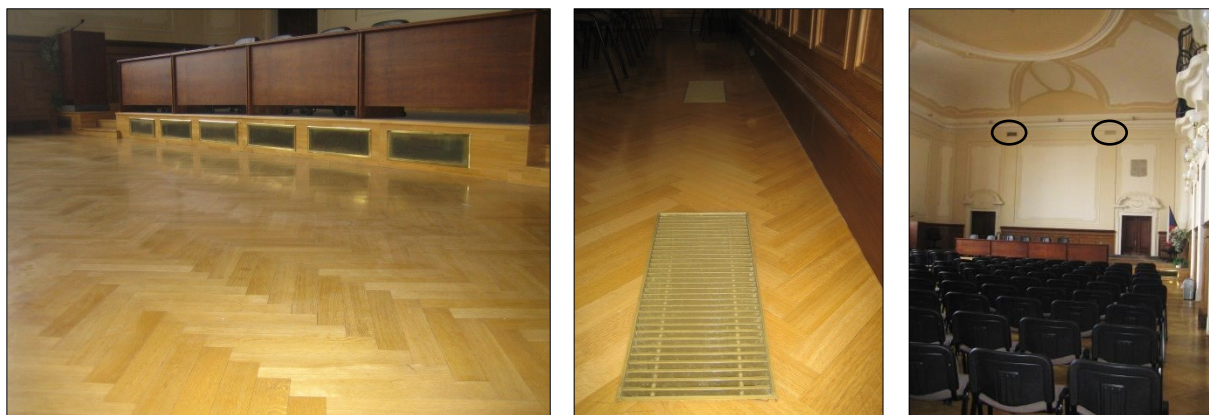
Obr. 5.2.2.14 Historická aula FAST – přírodní vyústky umístěné pod pódium v přední části auly (vlevo), přírodní podlahové vyústky v zadní části auly (uprostřed), odvodní vyústky po obvodu auly ve 2/3 výšky místnosti – zvýrazněné elipsami (vpravo) [zdroj: autor]
