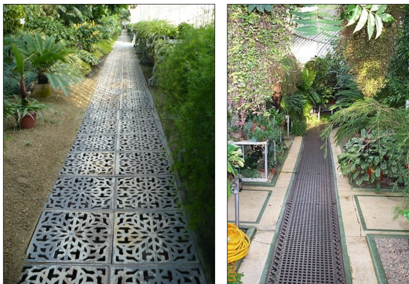
Obr. 6.3.1.7 Palmový skleník v Lednici - pohled na mřížky zděného kanálu, ve kterém jsou skryty teplovodní registry – současný stav (vlevo) [zdroj: autor]; The Palm House of Belfast - topný kanál s pochozí mřížkou – teplovodní systém instalovaný firmou Musgrave & Co Ltd. of Belfast [zdroj: [49]]
