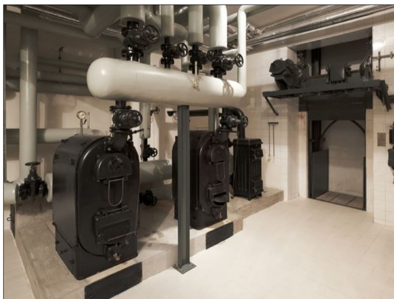
Obr. 5.2.2.28 Vytápění ve vile Tugendhat – teplovodní kotelna zrestaurovaná při památkové obnově v letech 2010 - 2012 do původní podoby z doby výstavby [zdroj: David Židlický [18]]
