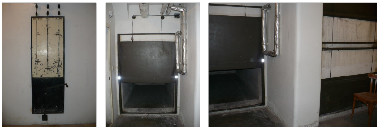
Obr. 5.2.2.11 Vila Tugendhat – komponenty systému nuceného větrání: manuální regulační panel (vlevo), pohled na „regulační klapku“ komory cirkulačního vzduchu (uprostřed), pohled na otevřenou „regulační klapku“ komory cirkulačního vzduchu a na zavřené „regulační klapky“ komory čerstvého vzduchu /horní komora/ a chlazeného vzduchu /spodní komora/ (vpravo) [zdroj: autor]
