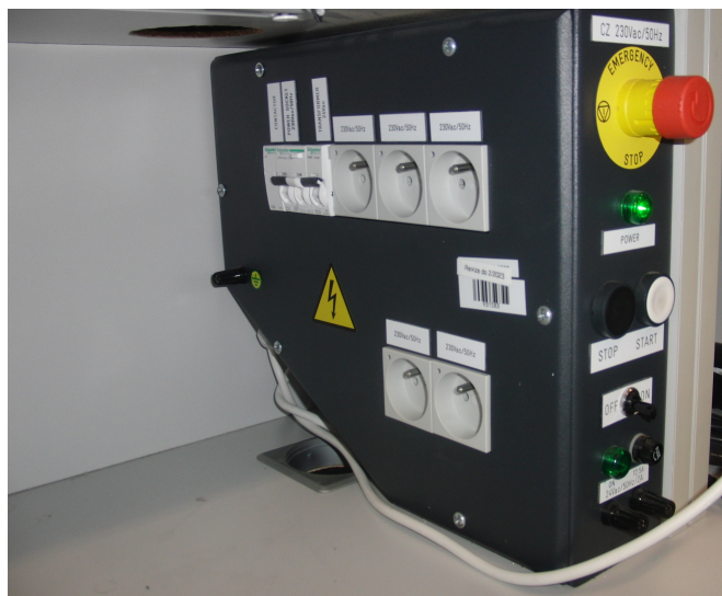
Obr. 2.1: Rozvaděč s jisticími prvky a výstupem 24 V~.
