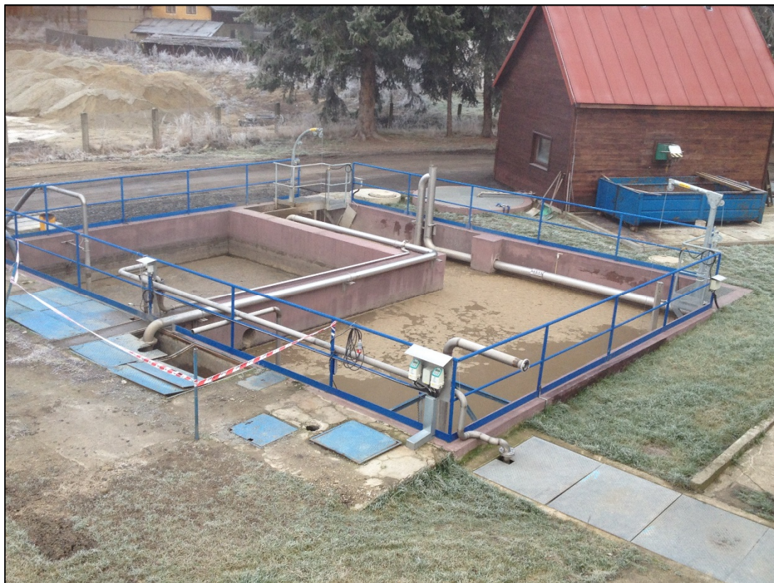
Foto 3 Nádrže denitrifikace I a II
