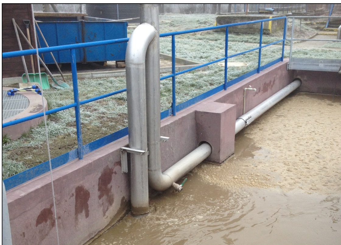
Foto 8 Zaústění interní recirkulace do denitrifikace II
