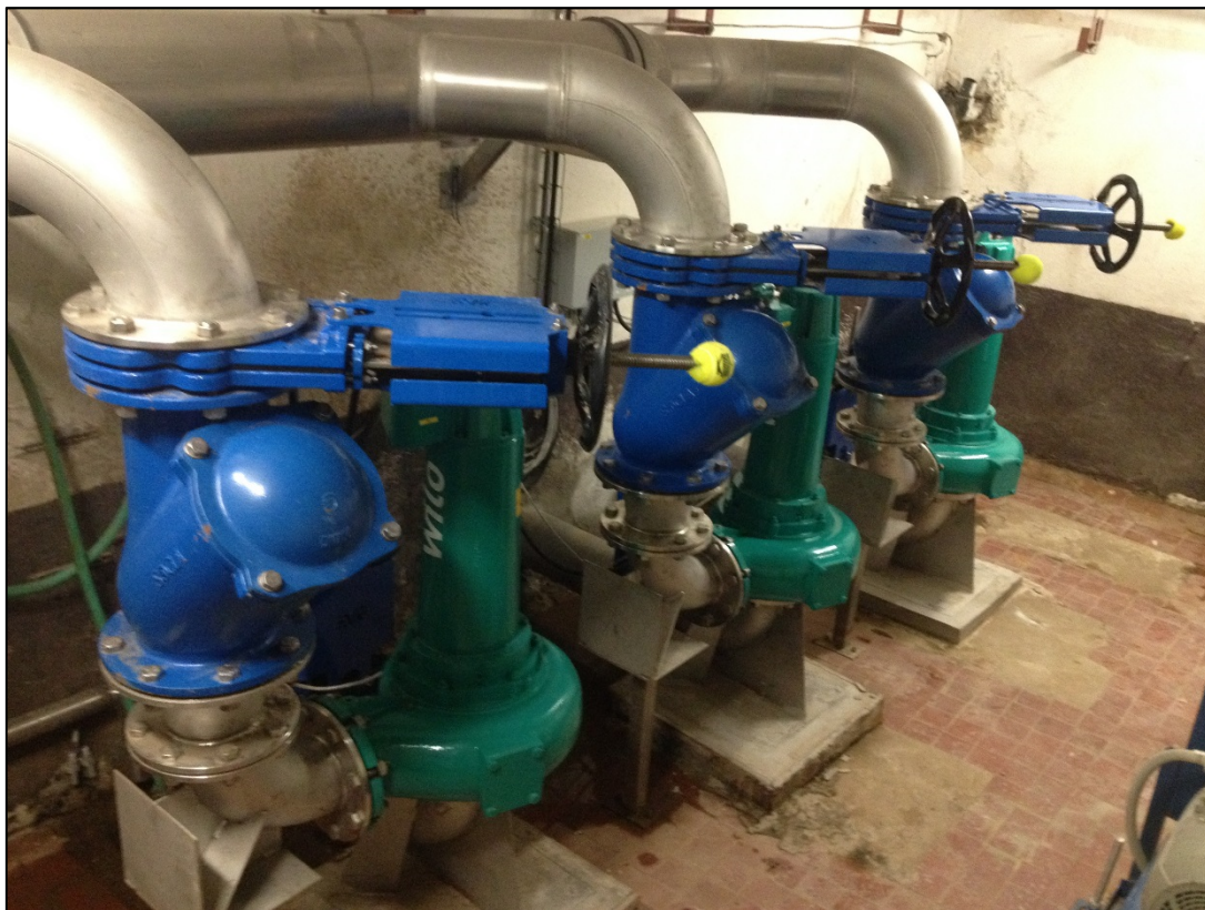
Foto 9 Čerpadla v čerpací stanici
