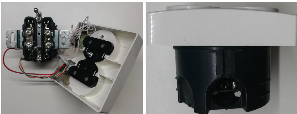
Obr. A.4: a) Instalace modemu do zásuvkové krabice b) Pohled na instalovaný modul
