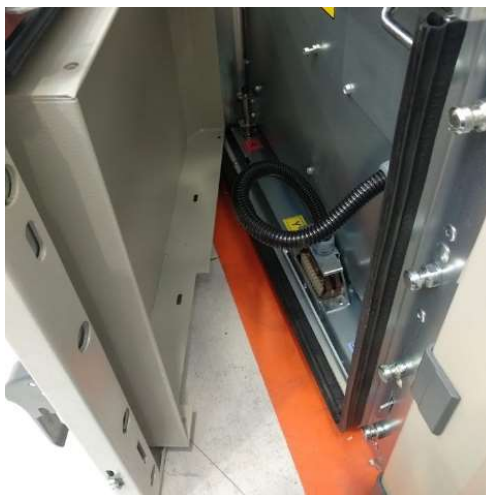
Obr. 6-5 Výřez do plechu dveří kabelového prostoru rozváděče
