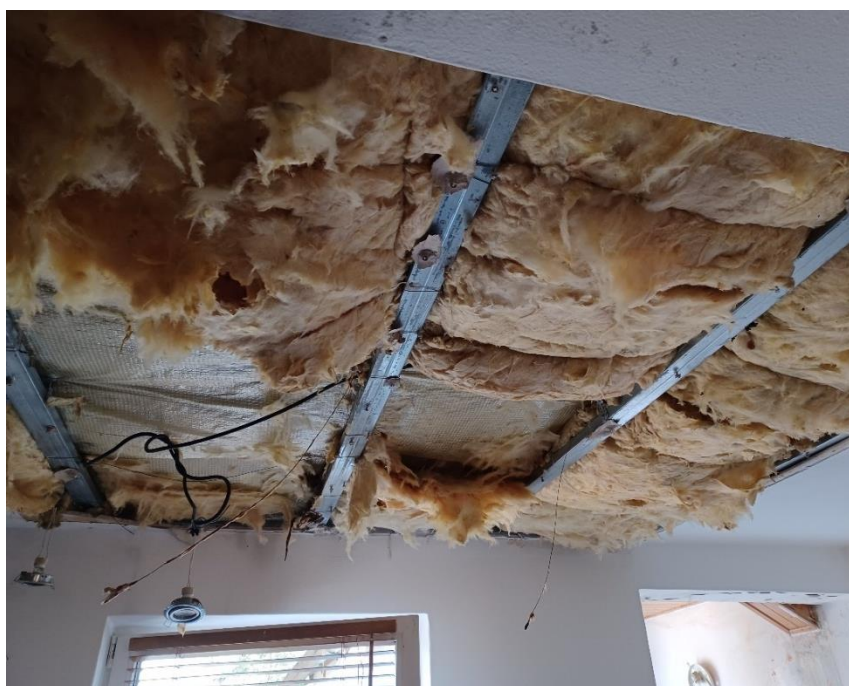
Obrázek 21: Poškozené pohledy od hasebního zásahu
