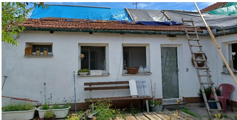
Obrázek 15: Pohled na přistavěnou obytnou část po požáru, na níž navazují dílny
