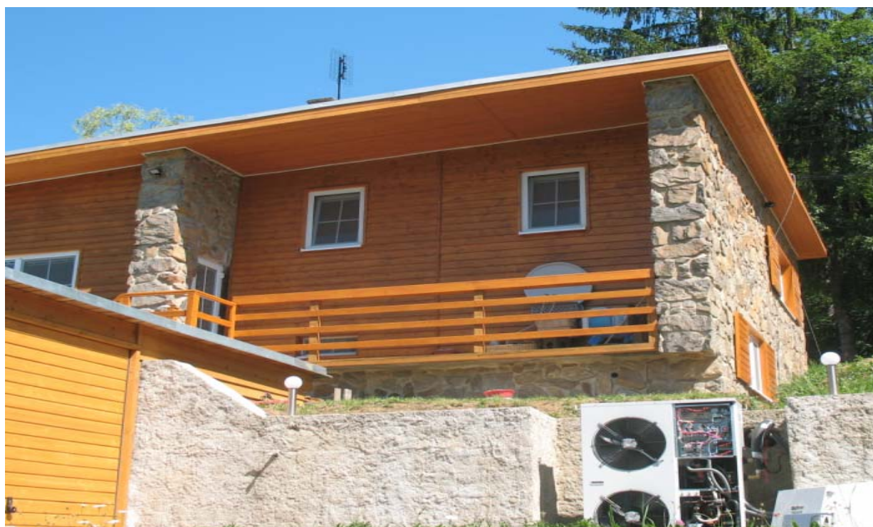
Obrázek 16 Rodinný dům v obci Skryje 31, umístění tepelného čerpadla vzduch - voda
