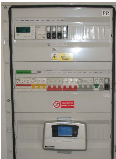
Obrázek 19 Rozvaděč tepelného čerpadla
