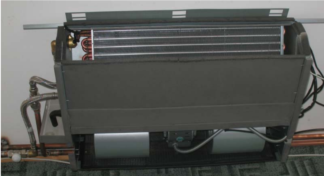
Obrázek 23 Pohled na vnitřek fan coilu
