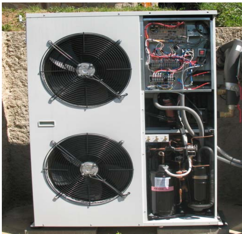
Obrázek 17 Rodinný dům v obci Skryje 31, tepelného čerpadla vzduch - voda
