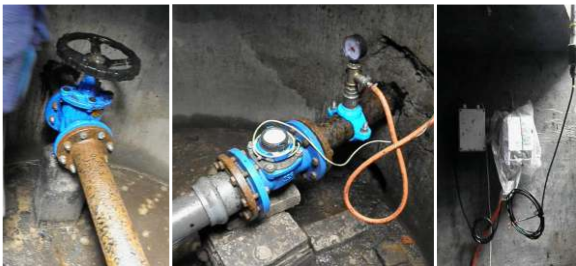
Obr. 3.5 Vystrojení vodoměrné šachty Š8 – šoupě (vlevo), vodoměr, data logger (vpravo)
