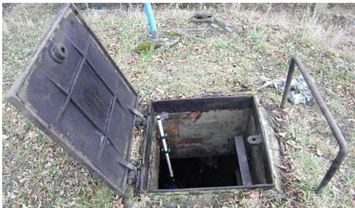
Obr. 3.4 Napojovací šachta RVS Hnojník na OOV – šachta Š8 – vstup
