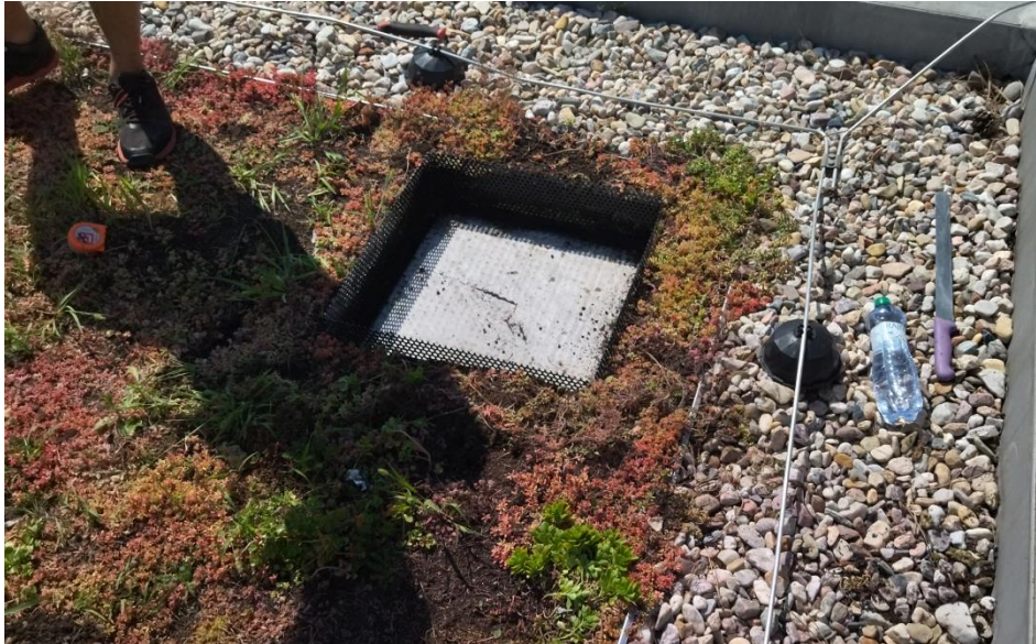
Obr. 29 - Implementace kontrolního segmentu na MŠ Řezáčova 3 [zdroj: autor, 2022]
