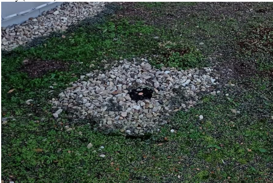
Obr. 51 - Obsypaná střešní vpust [zdroj: autor, 2022]
