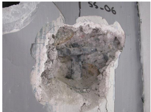
Obr. 91 Fotografie odhalené výztuže
