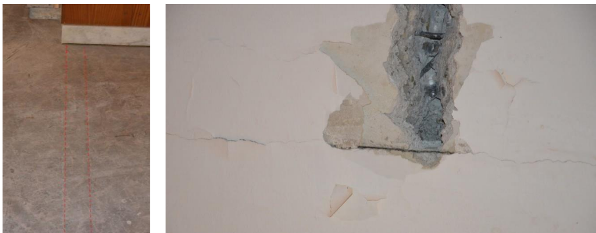
Obr. 33 Vlevo – podlaha ve 2.NP s viditelnou ohraničenou dilatační spárou v linoleu, vpravo – stropní konstrukce nad 2.NP v místě provedené sondy za účelem ověření vyztužení krajního nosníku s viditelnou dilatační spárou mezi jednotlivými konstrukčními prvky
