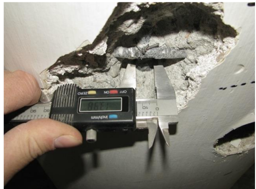
Obr. 90 Fotografie odhalené výztuže s pohledem na fenolftaleinový test karbonatice povrchových vrstev betonu
