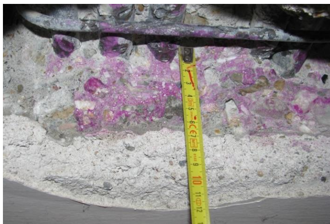
Obr. 22 Detail na sekanou sondu SP(01), kde zkouška karbonatace dosahuje do hloubky 10 mm
