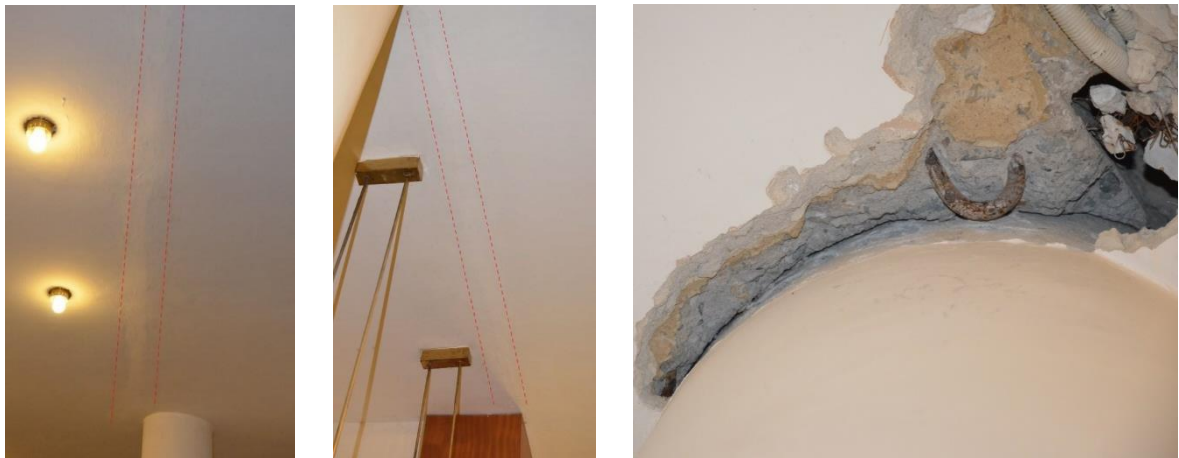
Obr. 32 Vlevo – fotografie ze vstupního prostoru do objektu s ohraničenou dilatační spárou mezi původním objektem a přístavbou, vpravo – detail provedené sekané sondy styku původních konstrukcí a přístavby
