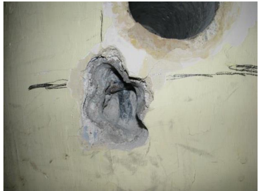
Obr. 86 Fotografie odhalené výztuže
