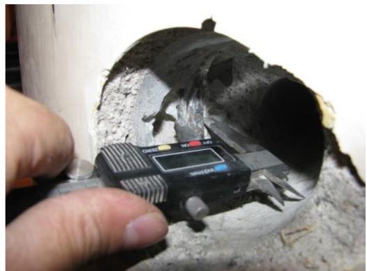
Obr. 87 Fotografie odhalené výztuže s pohledem na měření průměru výztuže
