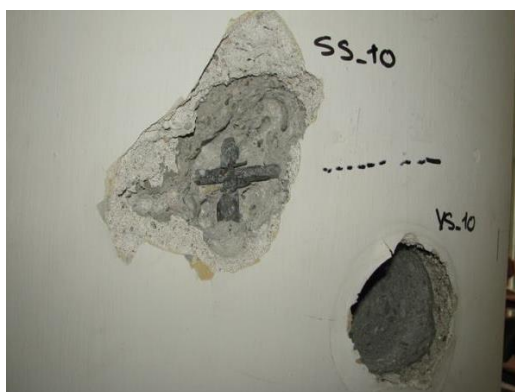
Obr. 95 Fotografie odhalené výztuže
