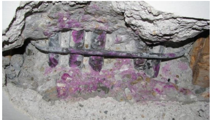
Obr. 99 Fotografie určení vyztužení stropního průvlaku uprostřed rozpětí na ohybový moment u dolního líce
