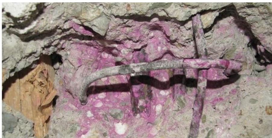
Obr. 24 Určení vyztužení spodní výztuže uprostřed rozpětí zesíleného stropního žebra vynášejícího konstrukci z obvodového sloupu v sondě ST(04)
