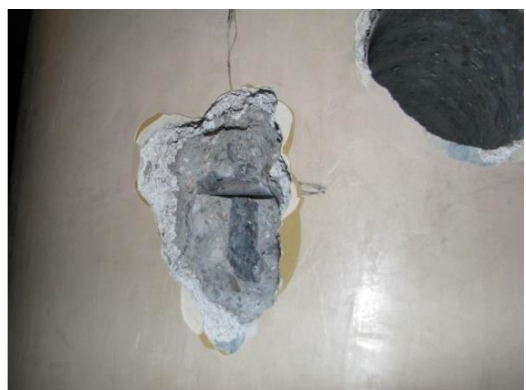
Obr. 88 Fotografie odhalené výztuže
