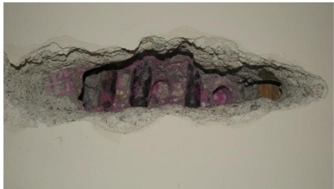
Obr. 100 Foto určení vyztužení průvlaku uprostřed rozpětí krajního pole na ohybový moment u dolního líce
