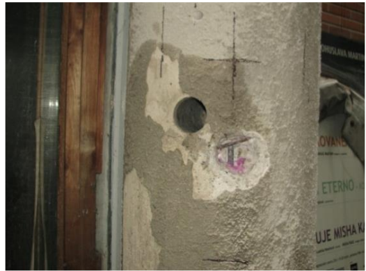
Obr. 89 Fotografie odhalené výztuže s pohledem na fenolftaleinový test karbonatice povrchových vrstev betonu
