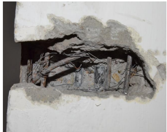
Obr. 155 Pohled ze spodního líce příčného trámu se sekanou sondou k odhalené nosné výztuži (řez 1-1')
