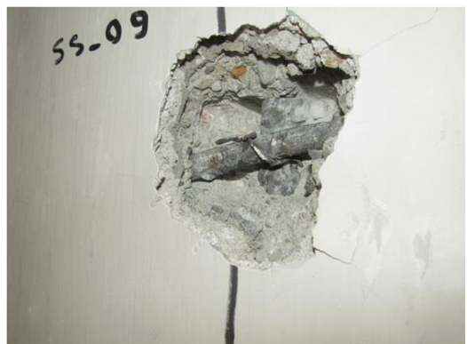
Obr. 94 Fotografie odhalené výztuže
