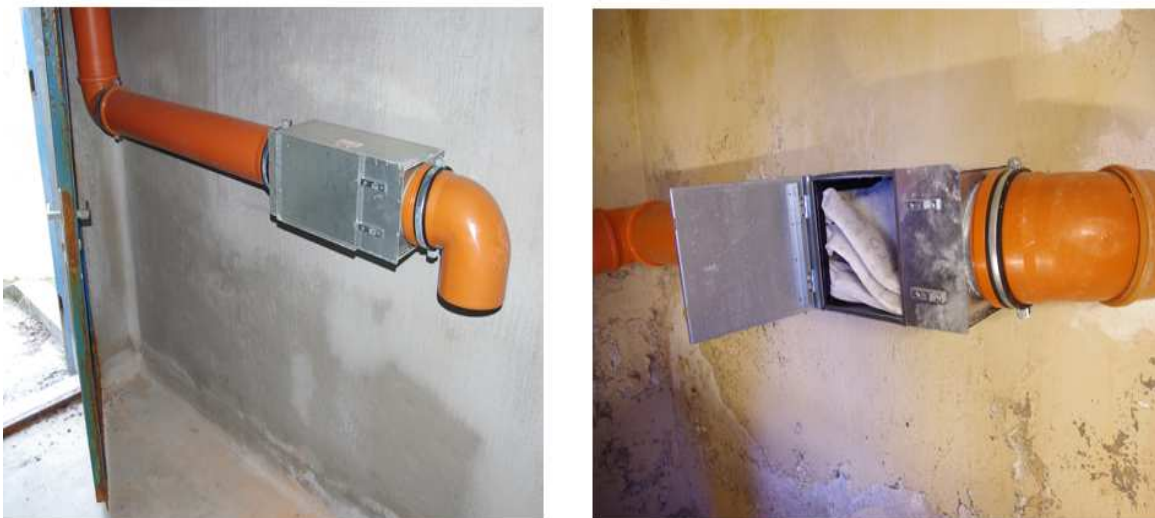
Obrázek 35 - Ventilační potrubí se stávajícími filtračními boxy
