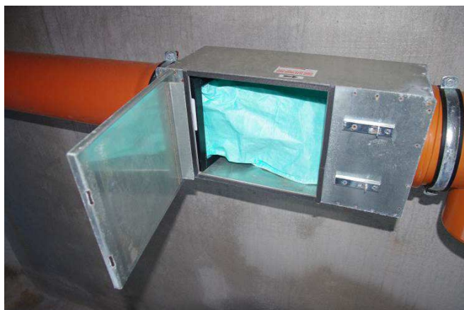
Obrázek 39 - Osazení nanovláknenného filtru do stávajícího filtračního boxu
