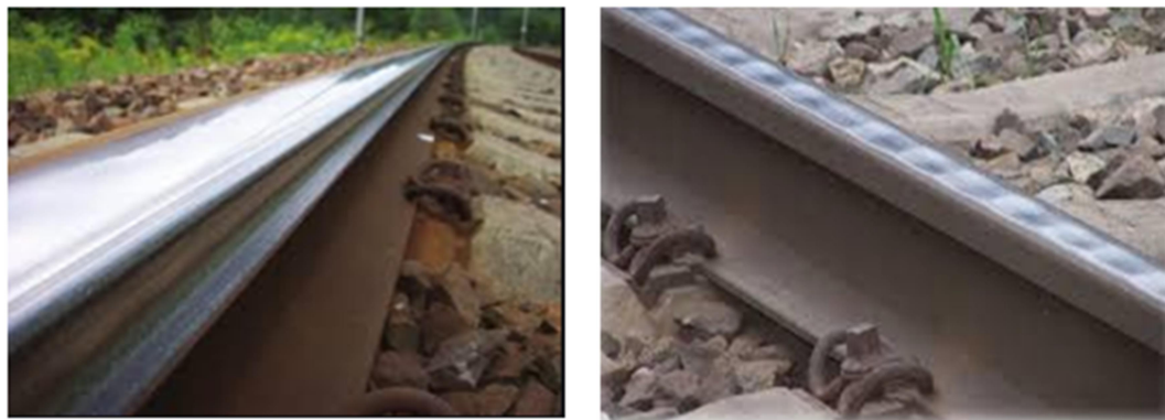
Obr. 18 Opotřebení styčných ploch na kolejnicích: vlevo opotřebení vnitřní strany hlavy kolejnice, vpravo vlnovitost [32], [33].
