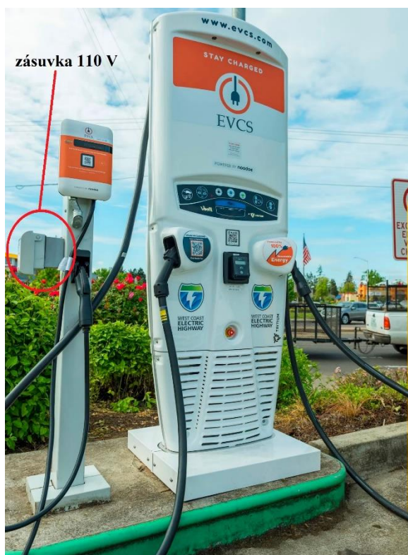
Obrázek 3.4 Zásuvka v rámci dobíjecí stanice elektrických automobilů [83]
