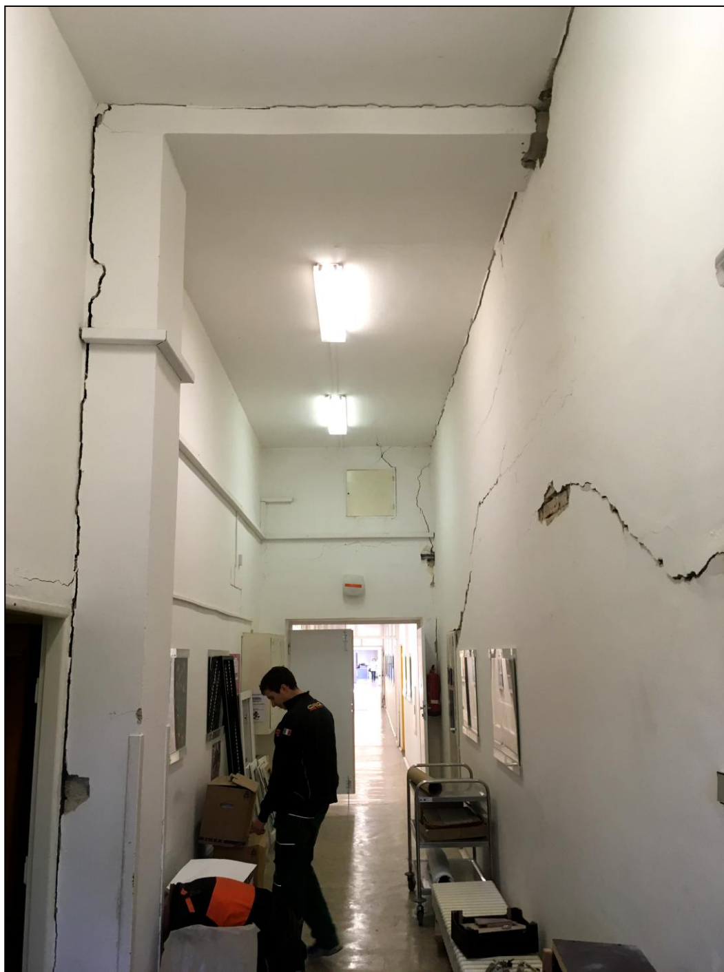
Obr. 20: Pohled na část poškozeného křídla
