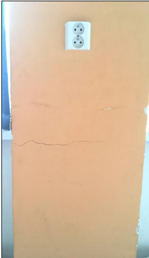
Obr. 27: Trhlina u paty sloupu
