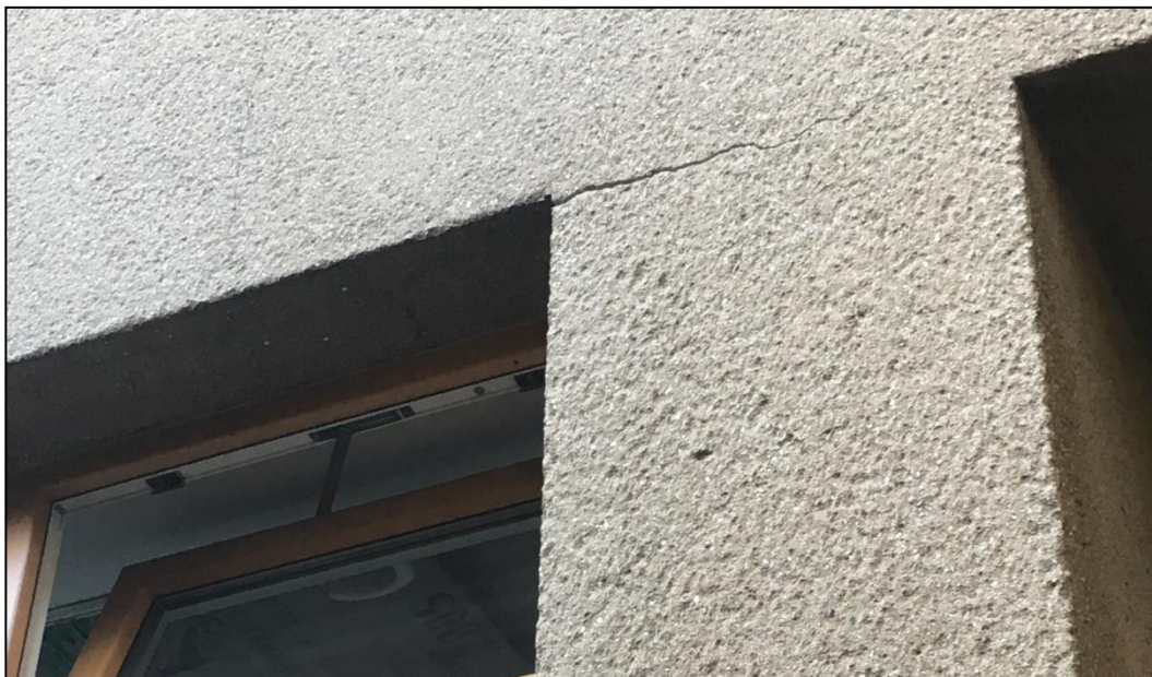
Obr. 29: Trhlina u hlavy sloupu v obvodovém plášti v nepodsklepené části
