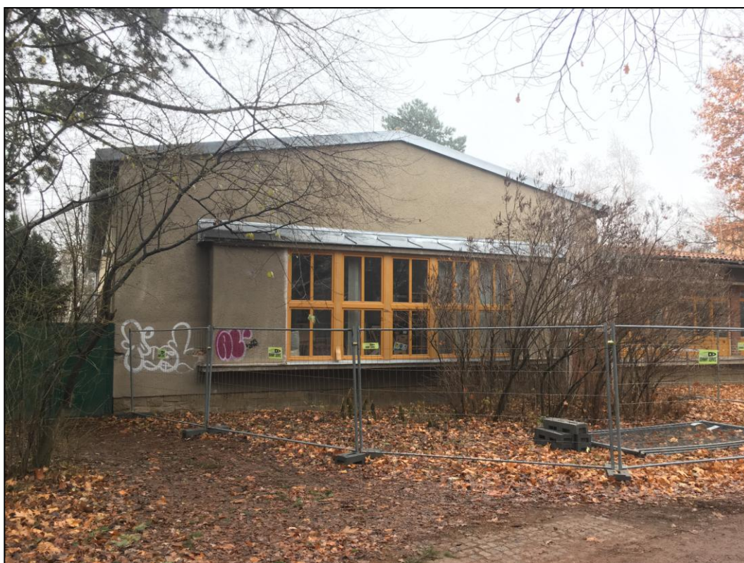
Obr. 6: Pohled zvenčí na porušenou část objektu s odtrhávajícím se arkýřem
