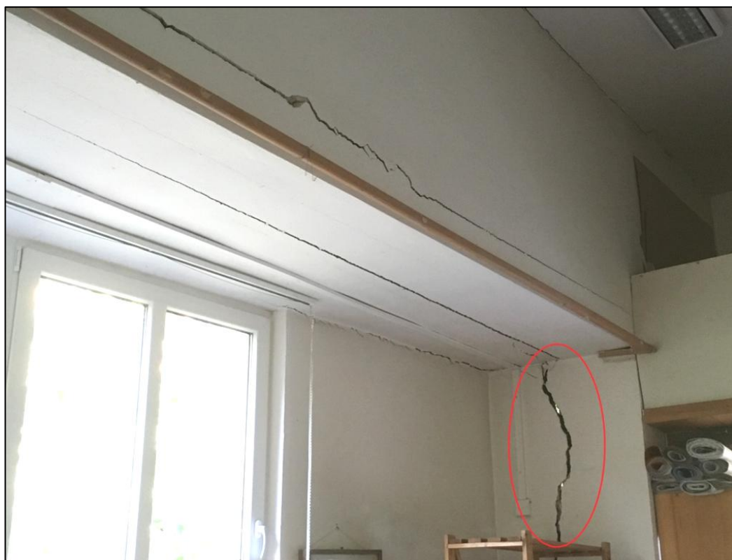
Obr. 24: Odtrhávající se arkýř od obvodového zdiva – šířka trhliny je až 40 mm
