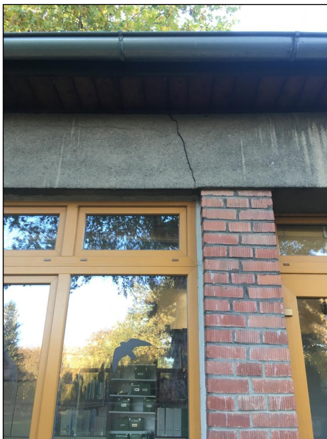
Obr. 23: Trhlinou porušený ŽB věnec – šířka trhliny je odhadem 10 mm
