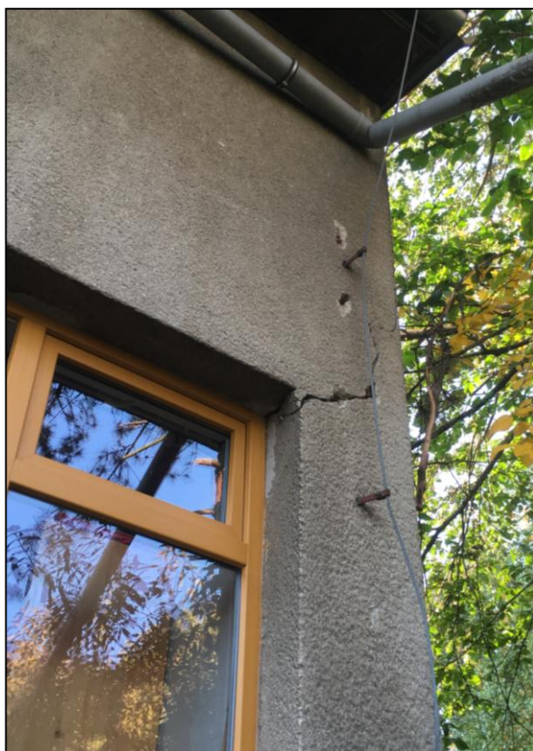
Obr. 19: Trhlina probíhající u nadokenního překlady
