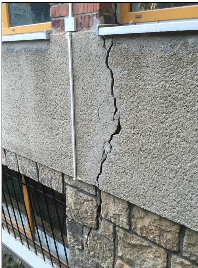
Obr. 14: Trhlina ve zdivu na hranici částí podsklepenou/nepodsklepenou
