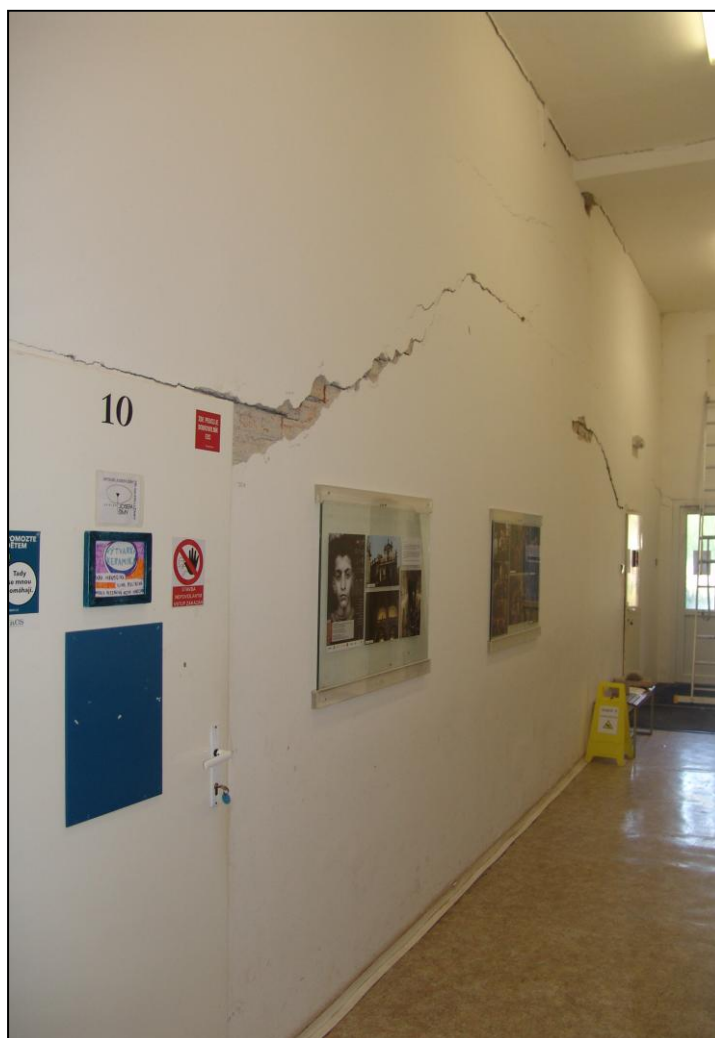
Obr. 25: Porušená příčka trhlinou mezi dvěma dveřními otvory
