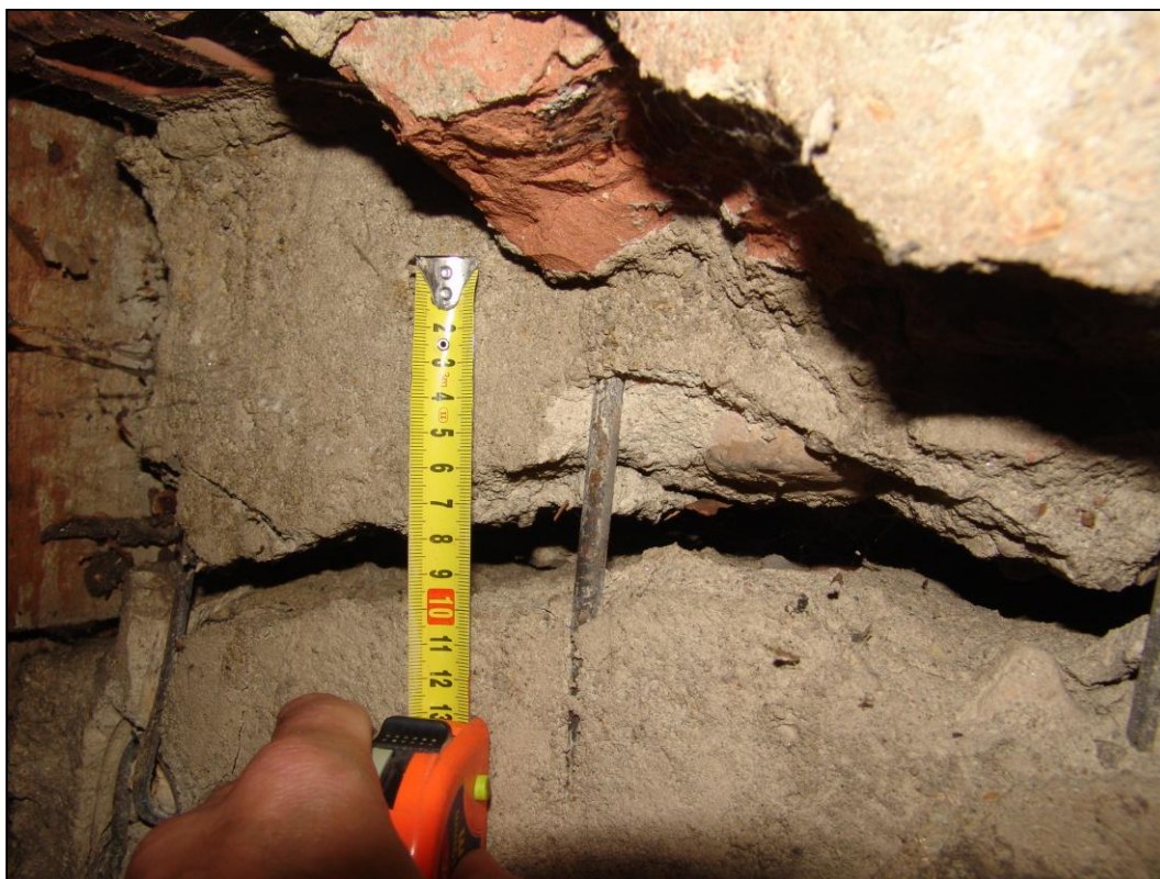
Obr. 16: Porušený železobetonový věnec – šířka trhliny je až 25 mm [23]
