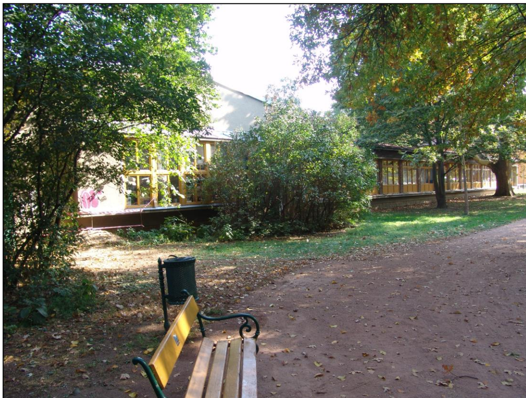
Obr. 9: Pohled na prosedající zeminu – čelo objektu [23]
