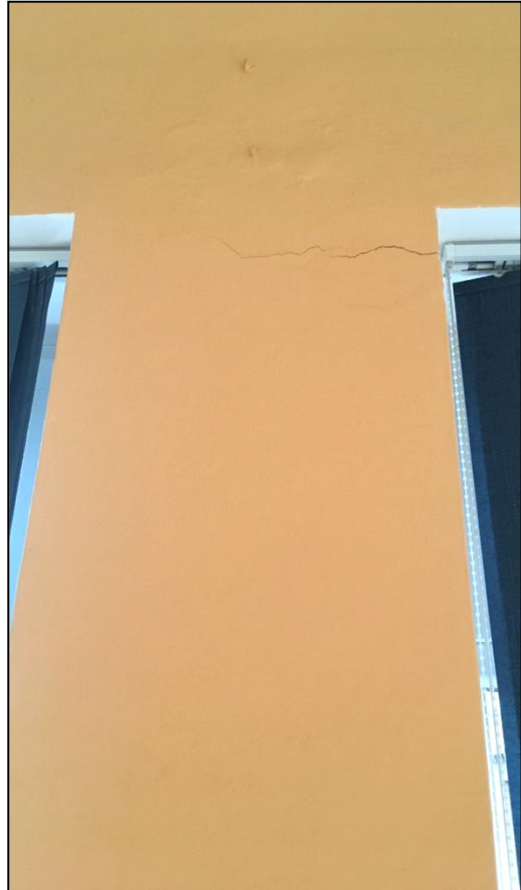
Obr. 28: Trhlina u hlavy sloupu
