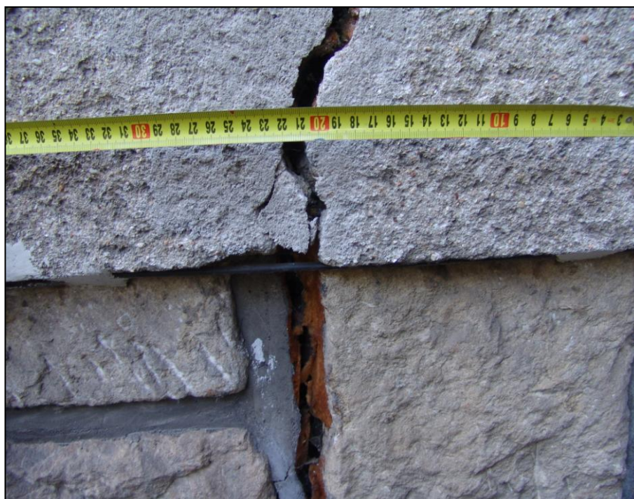
Obr. 15: Velikost trhliny dosahuje místy až 20 mm [23]
