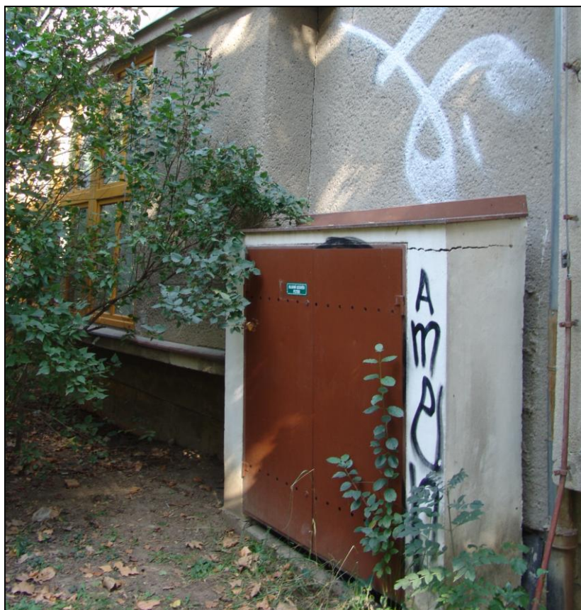
Obr. 10: Odkloněná a porušená skříňka HUP [23]
