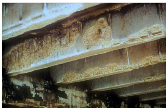
Obr. č. 9: Ukázka porušení betonové konstrukce po požáru [37]
