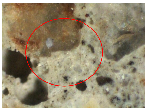
Obr. č. 97: Mikrotrhliny v cementovém tmelu po 250 °C
