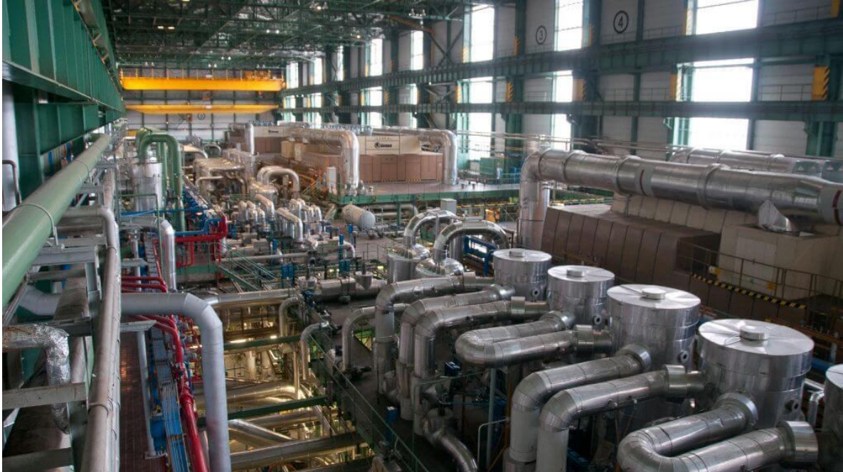
Obr. 2-1 Pohled na strojovnu 2. HVB [26]
