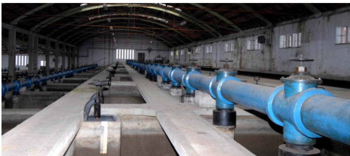
Obr. 6.13 ÚV Plzeň – hlavní hala
