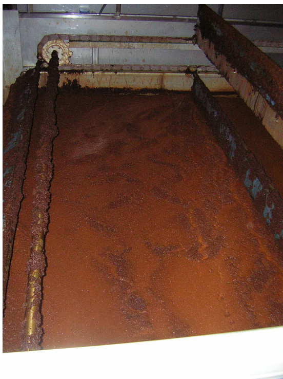
Obr. 6.5 ÚV Mostiště – flotační jednotka
