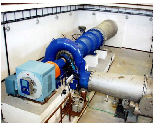
Obr. 6.1 ÚV Švařec – turbína
