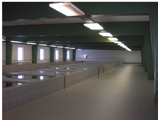
Obr. 6.26 ÚV Karolinka –hala filtrů
