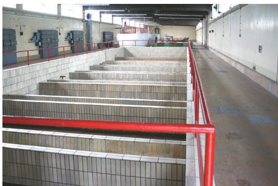
Obr. 6.38 ÚV Hradiště – hala s filtry
