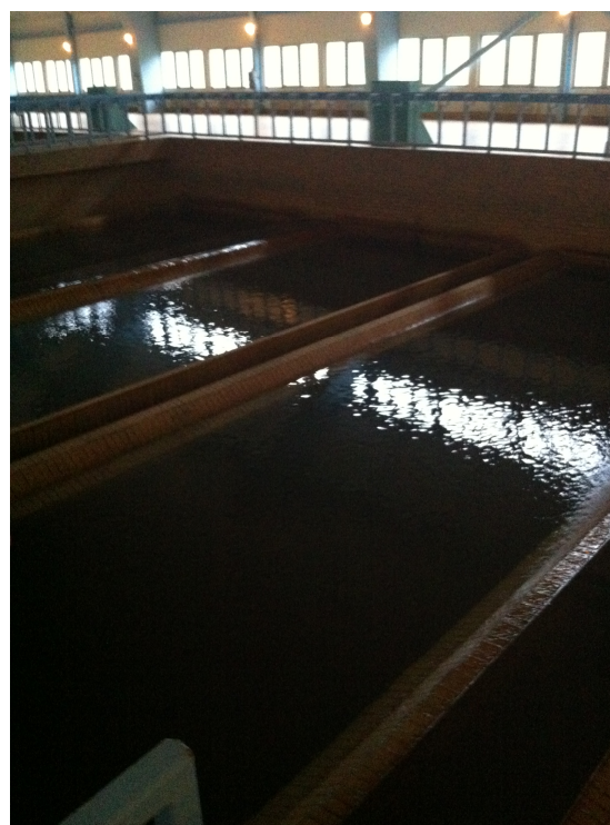
Obr. 5.7 ÚV Bedřichov – ot. rychlofiltry
