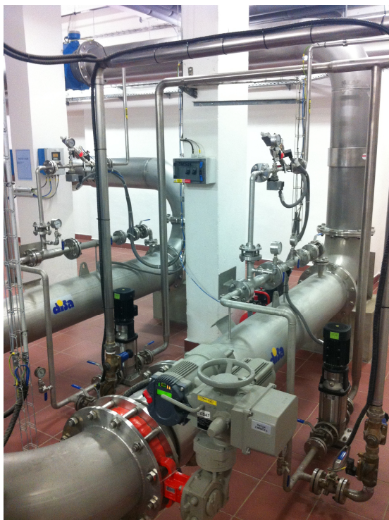
Obr. 6.16 ÚV Kroměříž – vstrojení provozu
