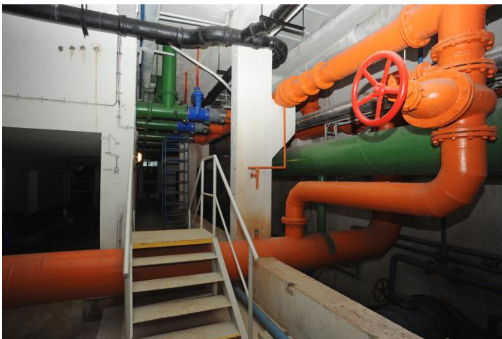
Obr. 6.20 ÚV Hradec Králové – armatury [zdroj: www.vakhk.cz ]
