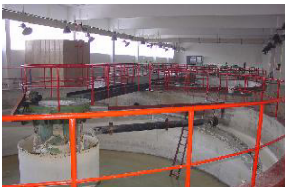
Obr. 6.32 ÚV Hradiště –míchací nádrže
