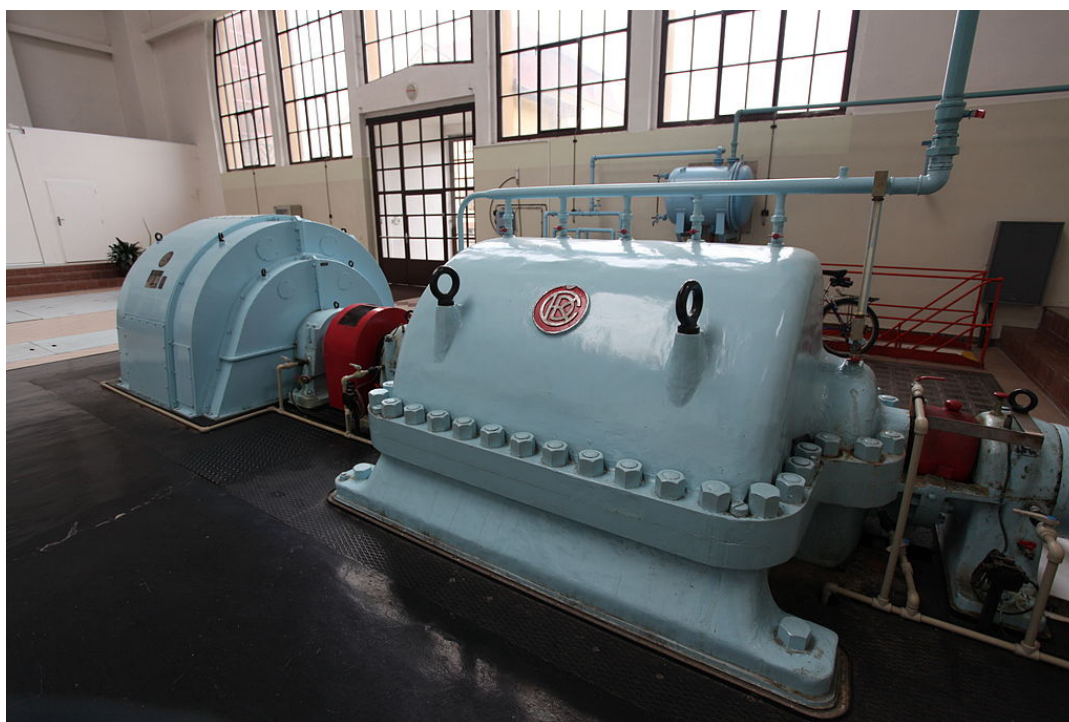
Obr. 6.22 ÚV Káraný – původní čerpadla [zdroj: www.wikipedia.cz ]
