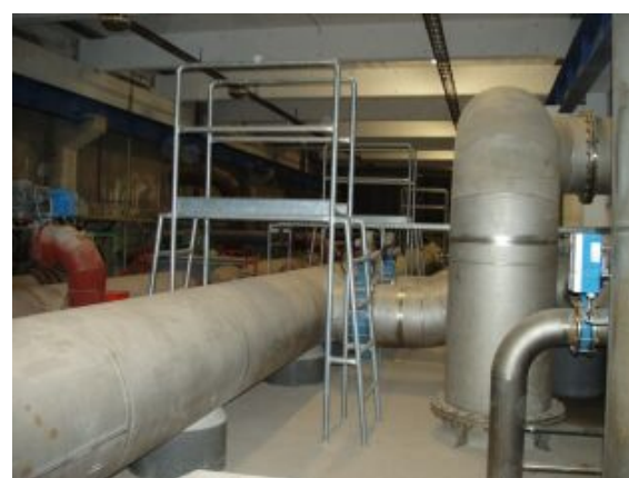
Obr. 6.35 ÚV Hradiště – armatury
