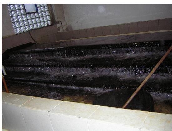
Obr. 6.7 ÚV Mostiště – kaskáda
