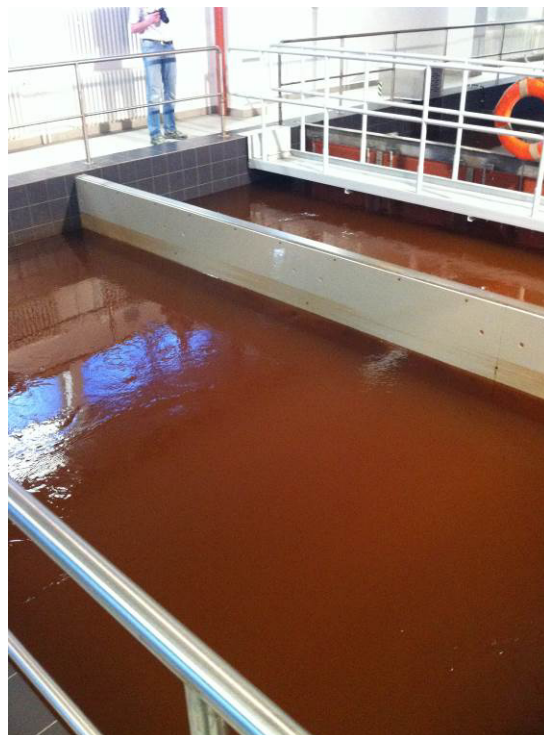
Obr. 5.3 ÚV Kroměříž – flok. nádrže
