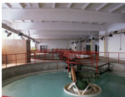
Obr. 6.39 ÚV Hradiště – míchací nádrž
