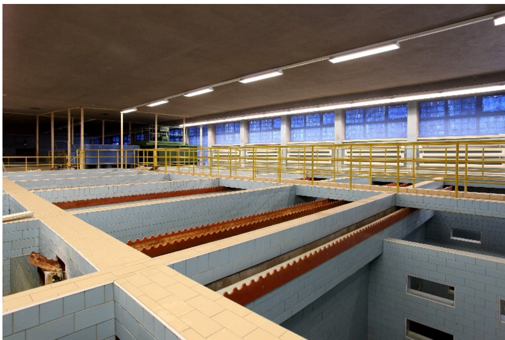
Obr. 6.19 ÚV Hradec Králové – hala filtrů [zdroj: www.vodohospodarske-stavby.cz ]
