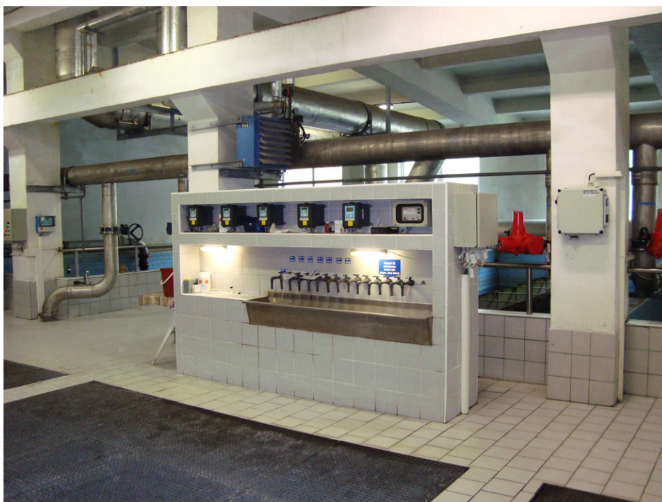
Obr. 6.42 ÚV Meziboří – výbava provozu [zdroj: www.svstv.cz ]
