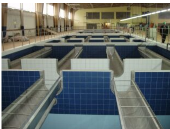
Obr. 6.34 ÚV Hradiště –filtry
