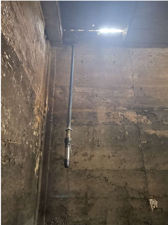
Obrázek 3-11 – Pohled na umístěnou sondu
