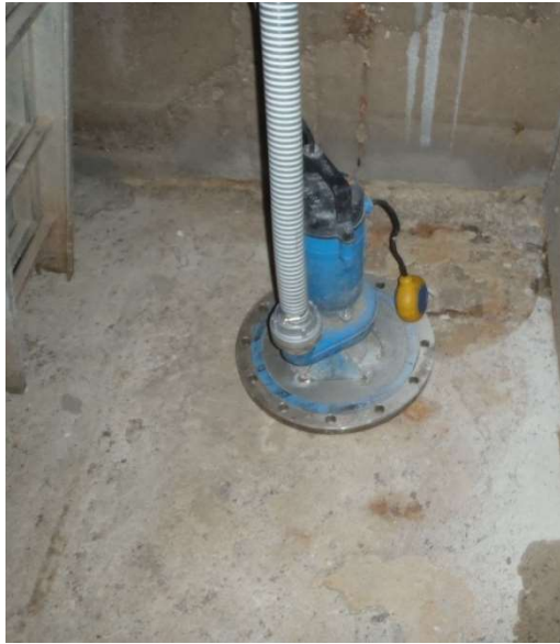
Obrázek 3-13 – čerpadlo umístěné v nádrži
