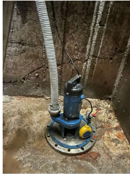
Obrázek 3-14 – čerpadlo umístěné v nádrži
