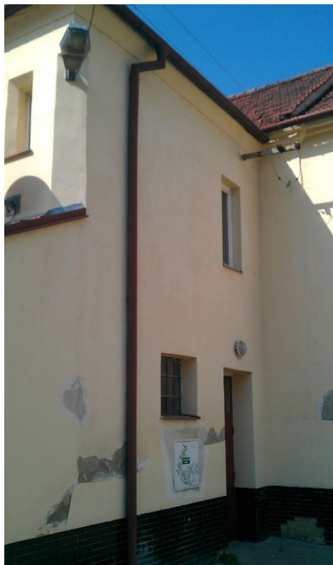
Obrázok 18 Poškodená obálka budovy
