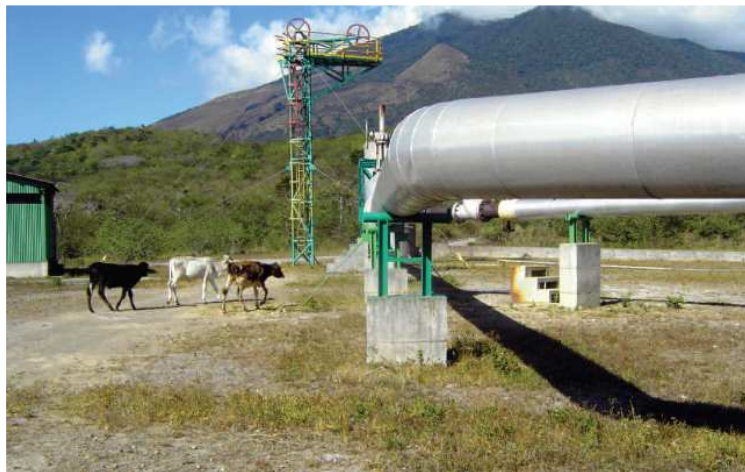
Obr. 3 Potrubí vedoucí z geotermální teplárny v Kostarice [10]
