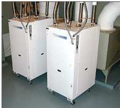
Obr. 20 Dva 36 tunová geotermální tepelná čerpadla použita na College of Southern Idaho [27]
