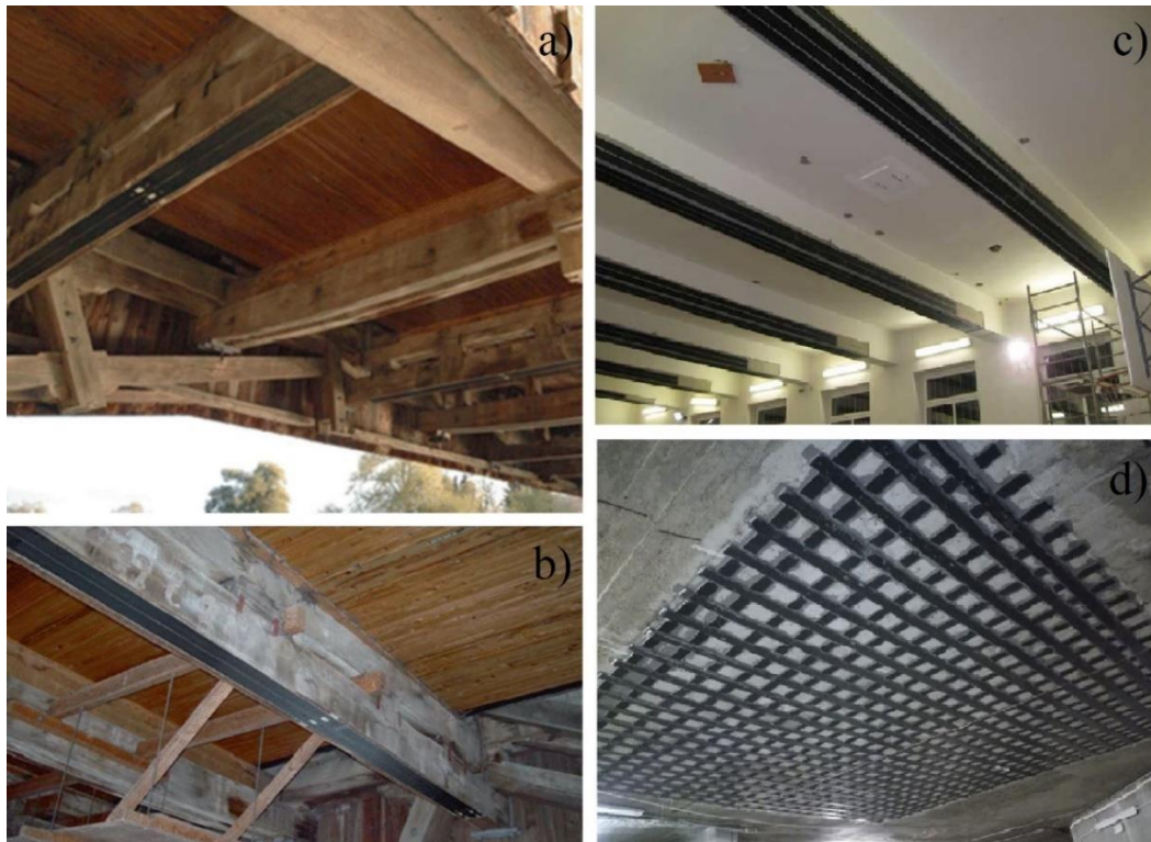
Obrázek 10) Ukázka způsobu dodatečného zesilování trámových a stropních konstrukcí pomocí uhlíkových CFRP lamel: a) + b) zesílení dřevěných trámových nosníků v ohybu, c) zvýšení ohybových a smykových pevností u železobetonového stropního nosníku, d) křížení CFRP lamel pro vyztužení stropní konstrukce. [29; 30]
