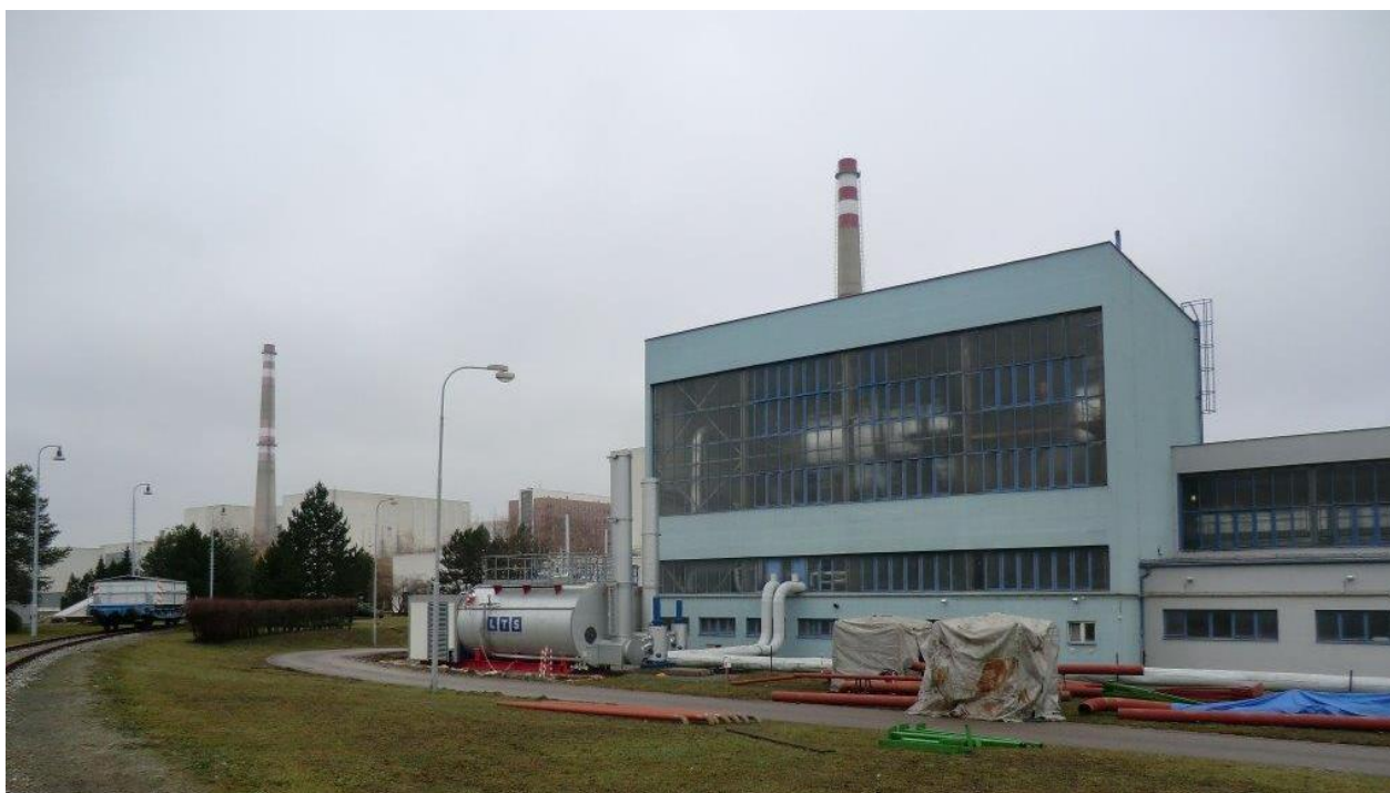
Obrázek 7-2: Zapojení mobilních kotlů k objektu pomocné kotelny [8].
