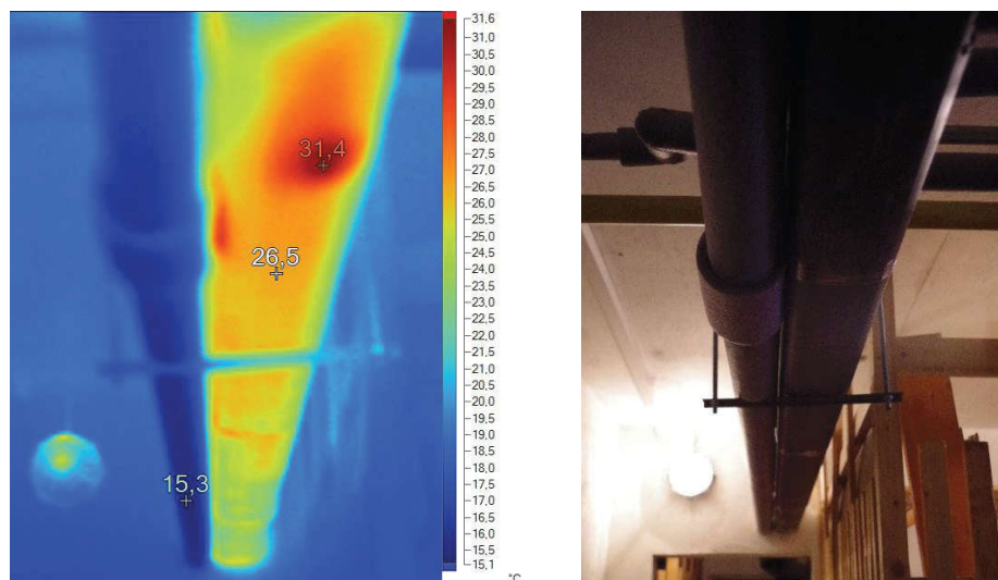
Obr. A.32 Nedostatečná tloušťka izolace rozvodů TV vedených v platovém žlabu
