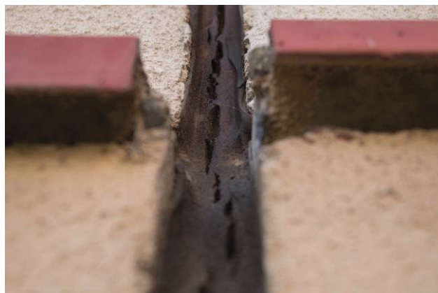
Obr. B.8 Stav těsnění dilatačních spár panelů
