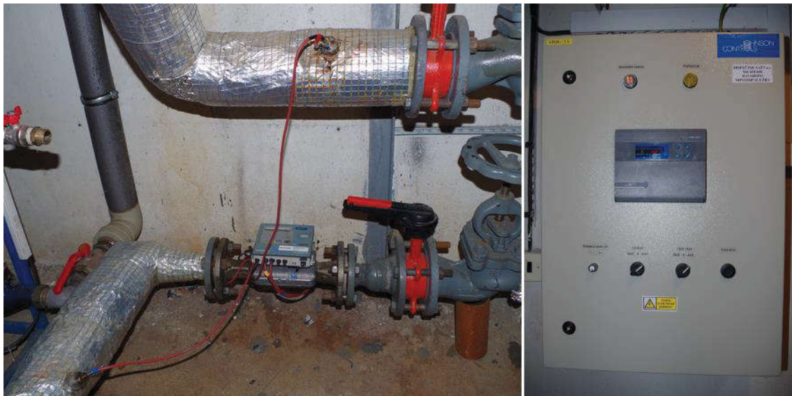
Obr. B.15 Měřící soustava tepla a rozvaděč s digitálním regulátorem
