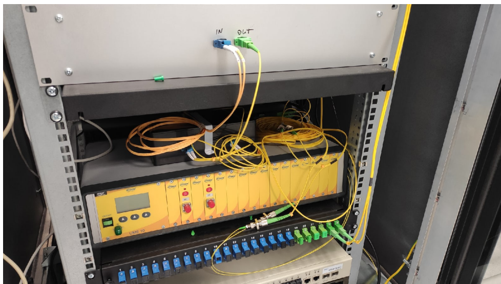
Obr. 6.4: Fotoukázka zapojení uvnitř racku.
