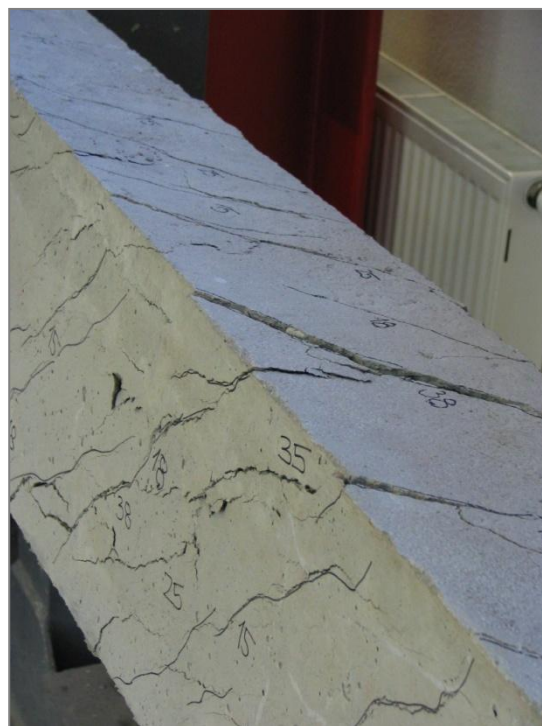
Obrázek 7-22 Detail trhlin N3 - 1
