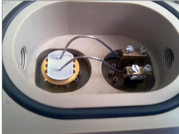
Obrázok 5.2 – Upravená komora zmiešavacej stanice
