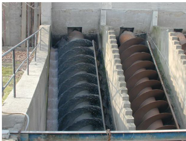
Obr. 5.5 Šneková čerpadla na vstupu do ČOV [27]
