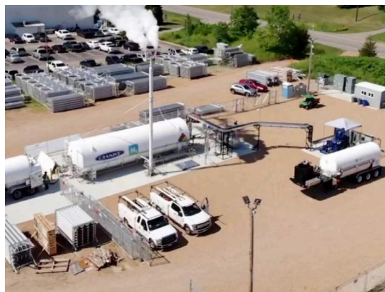
Obr. 15 Vodíková čerpací stanice [37]
