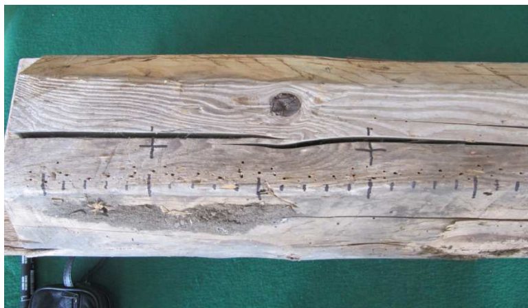
Obr. 30 Viditelné abiotické poškození prvku
