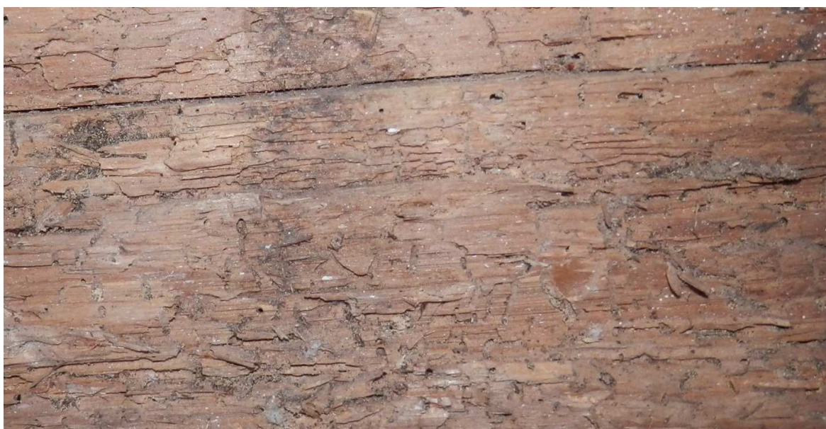
Obr. 31 Viditelné poškození prvku hmyzem
