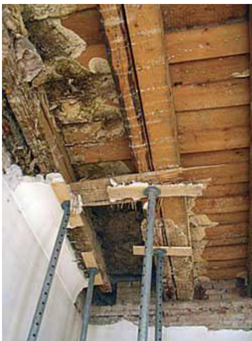
Obrázek 4. Fotografie dřevokazné houby na dřevěném stropu 5
