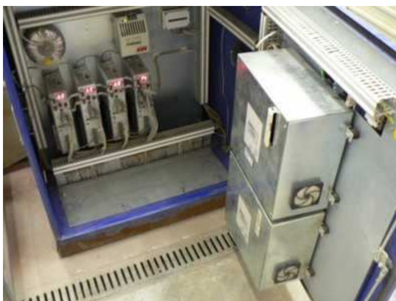
Obr. 1.6 Hardware řídicího systému ve slavkovské firmě E-COM
