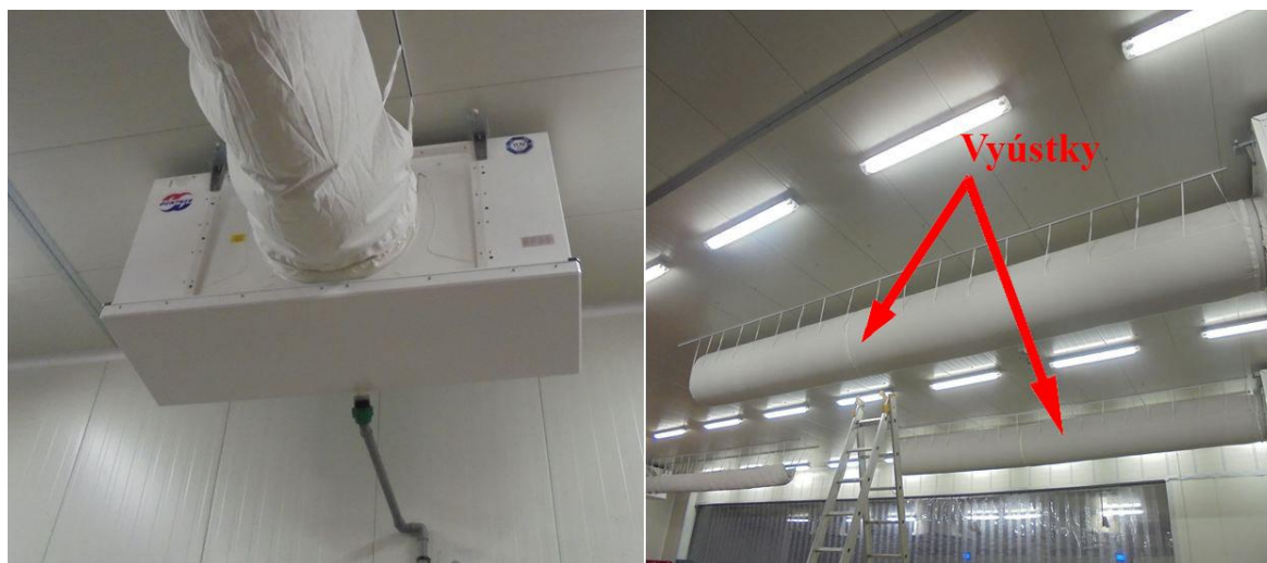
Obr. 43: Přístěnný výparník s axiálním ventilátorem, který je napojen na textilní vyústku
