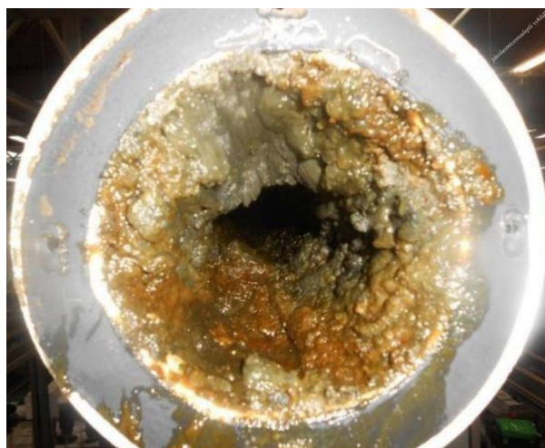
Obr. 26: Zanešení odtahového potrubí obráběcích NC strojů [42]
