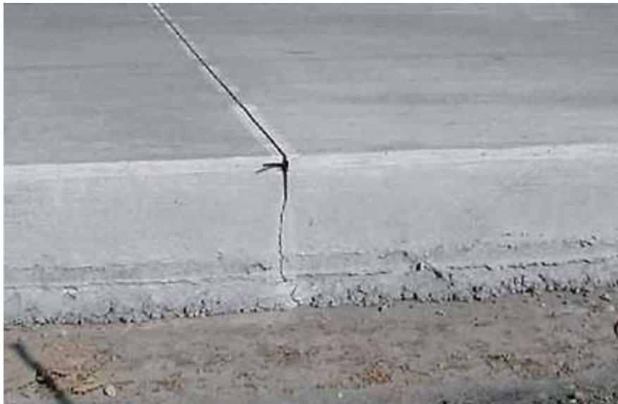
Obr. 1: Příčná smršťovací spára s pokračující trhlinou [3]
