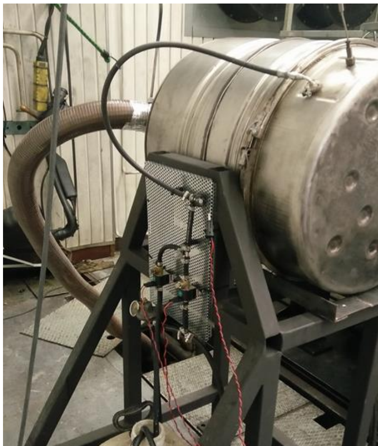
Obr. 46: Detail pohledu na zásobovací modul umístěného na stojanu pro SCR katalyzátor
