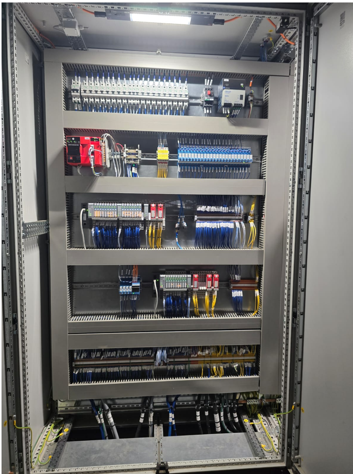
Obr. A.4: Foto el. rozvádzača s riadenými PLC
