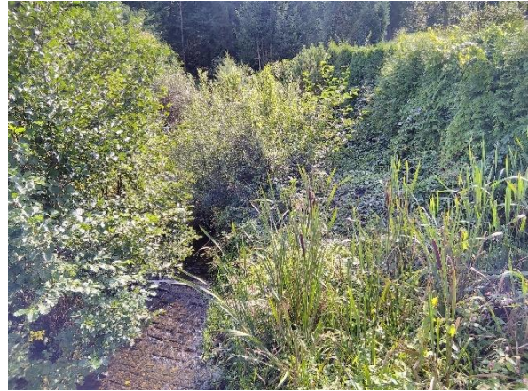
Obr. 47 - Úsek 5 - zarůstání koryta
