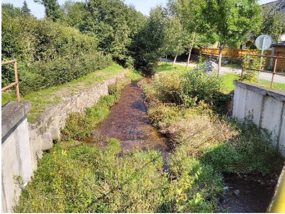
Obr. 48 - Úsek 5 - zarůstání koryta
