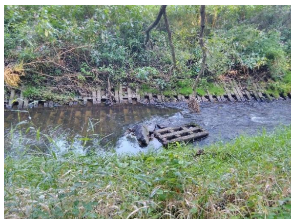
Obr. 28 – Úsek 1 – poškozené opevnění koryta
