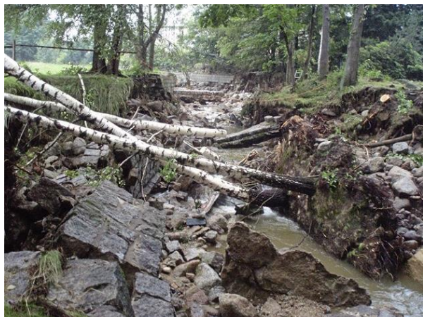
Obr. 7 - poškození koryta po povodni, foro: Lesy ČR, zdroj: www.idnes.cz
