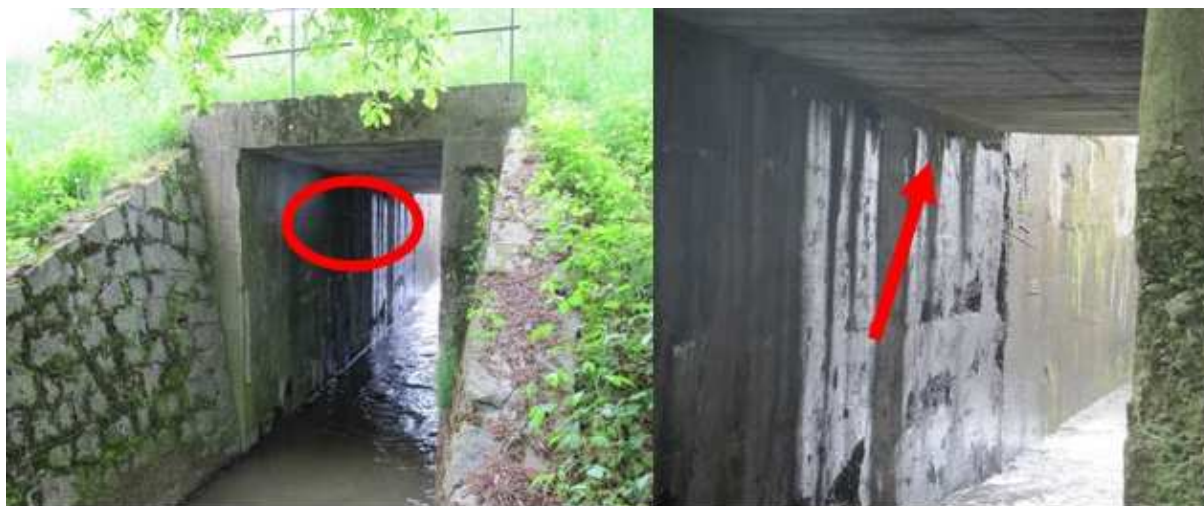
Obr. 4-2 Průsaky vody v propustku (detail – průsak vody ze stěn propustku) [18]
