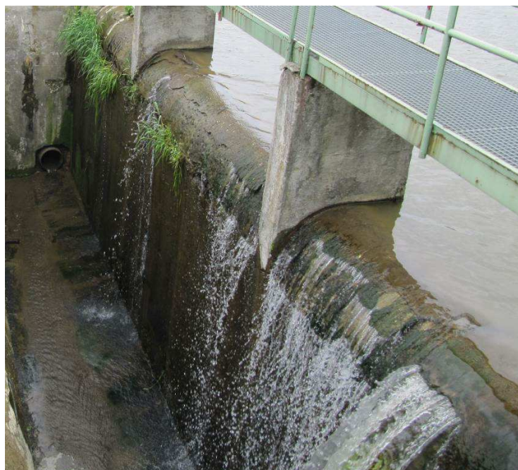
Obr. 3-1 Poškození bezpečnostního přelivu [18]
